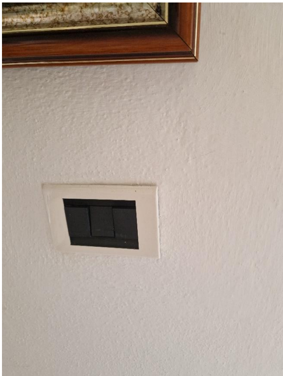
Dettagli finiture impianto elettrico
