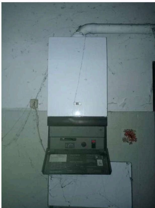
FOTOGRAFIA 44: vista della caldaia presente in cucina.
