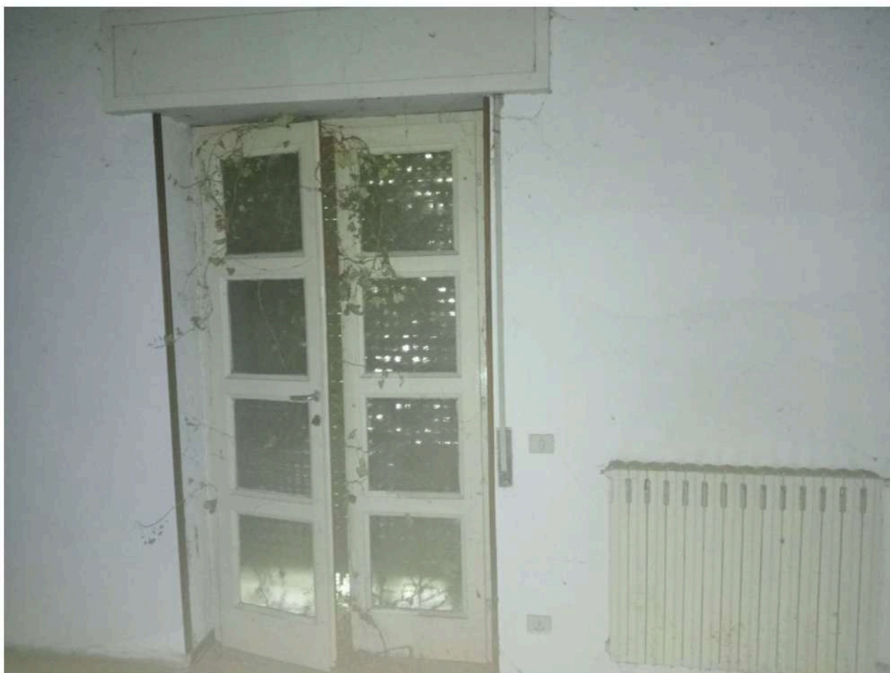
FOTOGRAFIE 37: dettaglio della porta finestra posta nella seconda camera da letto al piano primo, anch'essa invasa da rampicanti.
