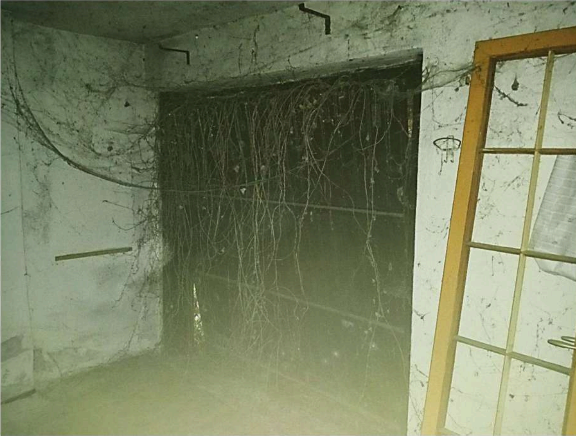
FOTOGRAFIA 22: vista della porta basculante dall'interno della lavanderia/autorimessa? invasa dalla vegetazione.
