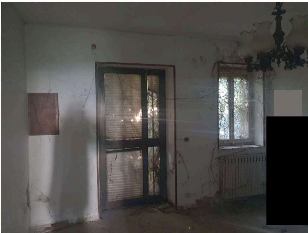
FOTOGRAFIA 28: vista del soggiorno da cui si dovrebbe accedere all'area verde comune retrostante la casa. (porta e finestra risultano bloccate dalla vegetazione infestante).
