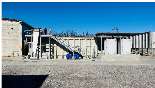
Edificio I – Impianto di depurazione
