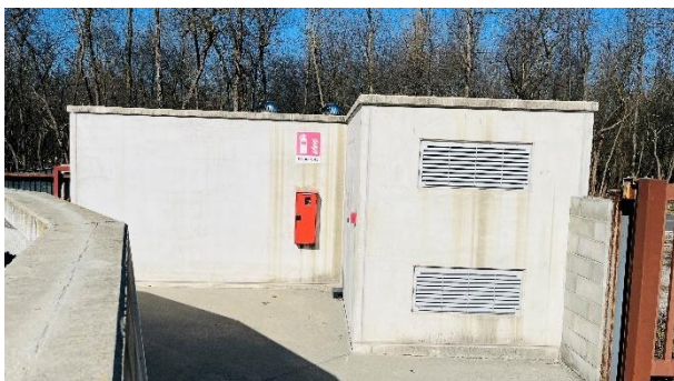
Edificio L – Cabina elettrica
