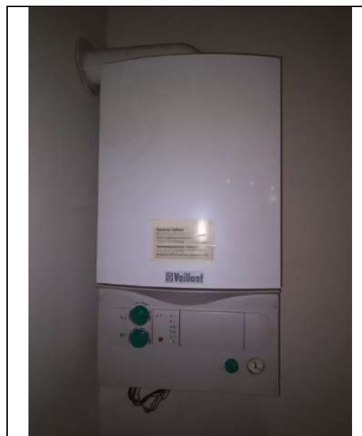
Foto 16. Particolare dello scaldino che gestisce la produzione di acqua calda sanitaria ed il riscaldamento dell'abitazione
