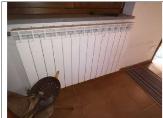
Foto 17. Particolari di uno dei termosifoni installati nell'abitazione, presente nella zona giorno al piano terra e nelle camere al piano primo e secondo
