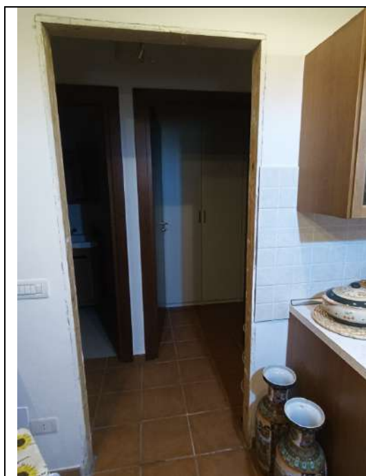
Foto 44. Particolare della porta mancante che consente di accedere al ripostiglio ed al bagno al piano terra
