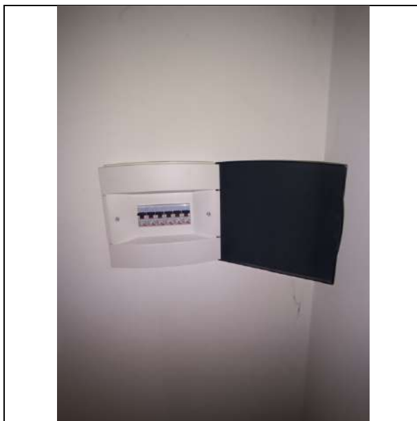
Foto 13. Particolare della tipologia di interruttori dell'impianto elettrico
