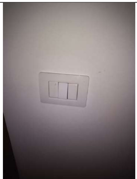
Foto 14. Particolare della tipologia di prese dell'impianto elettrico
