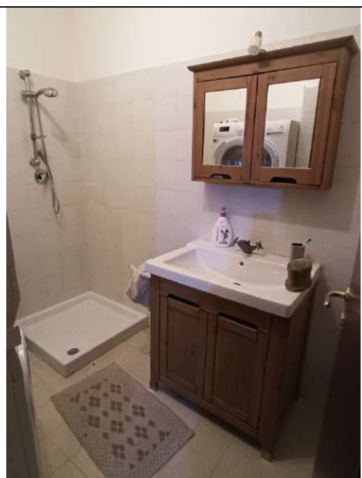
Foto 45. Particolare del box doccia mancante nel bagno al piano terra
