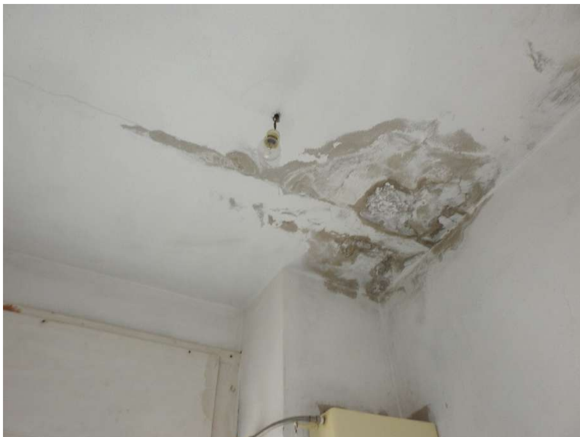
Figura 48 - Immobile 2 (negoziò), infiltrazioni bagno
