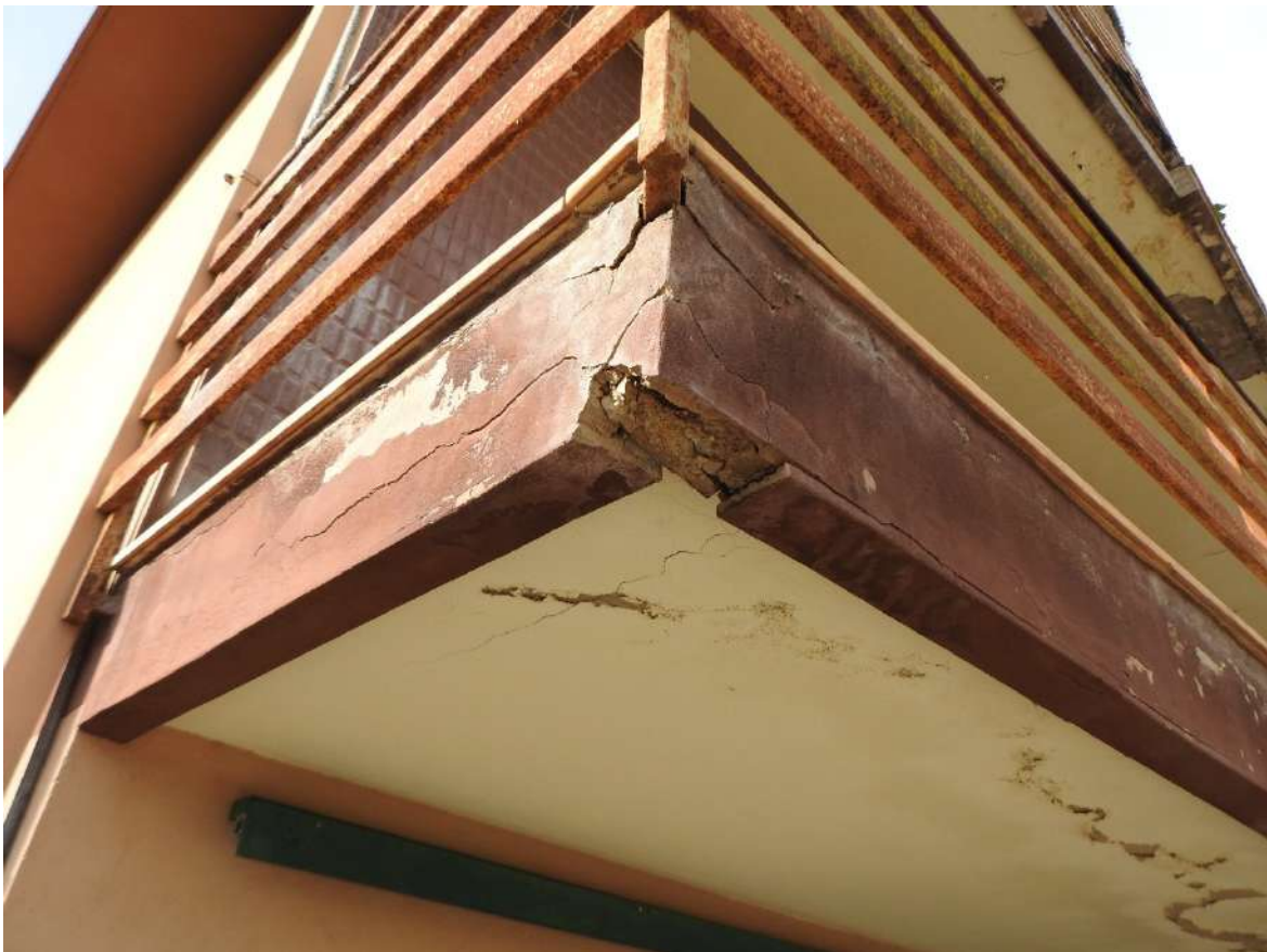
Figura 50 - Immobile 2 (negozio), degrado calcestruzzo balconata
