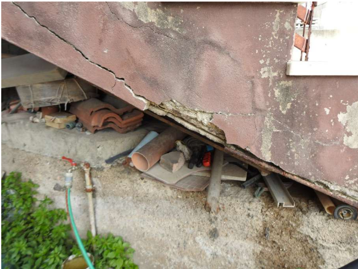
Figura 49 - Immobile 2 (negozio), degrado calcestruzzo scalinata di accesso
