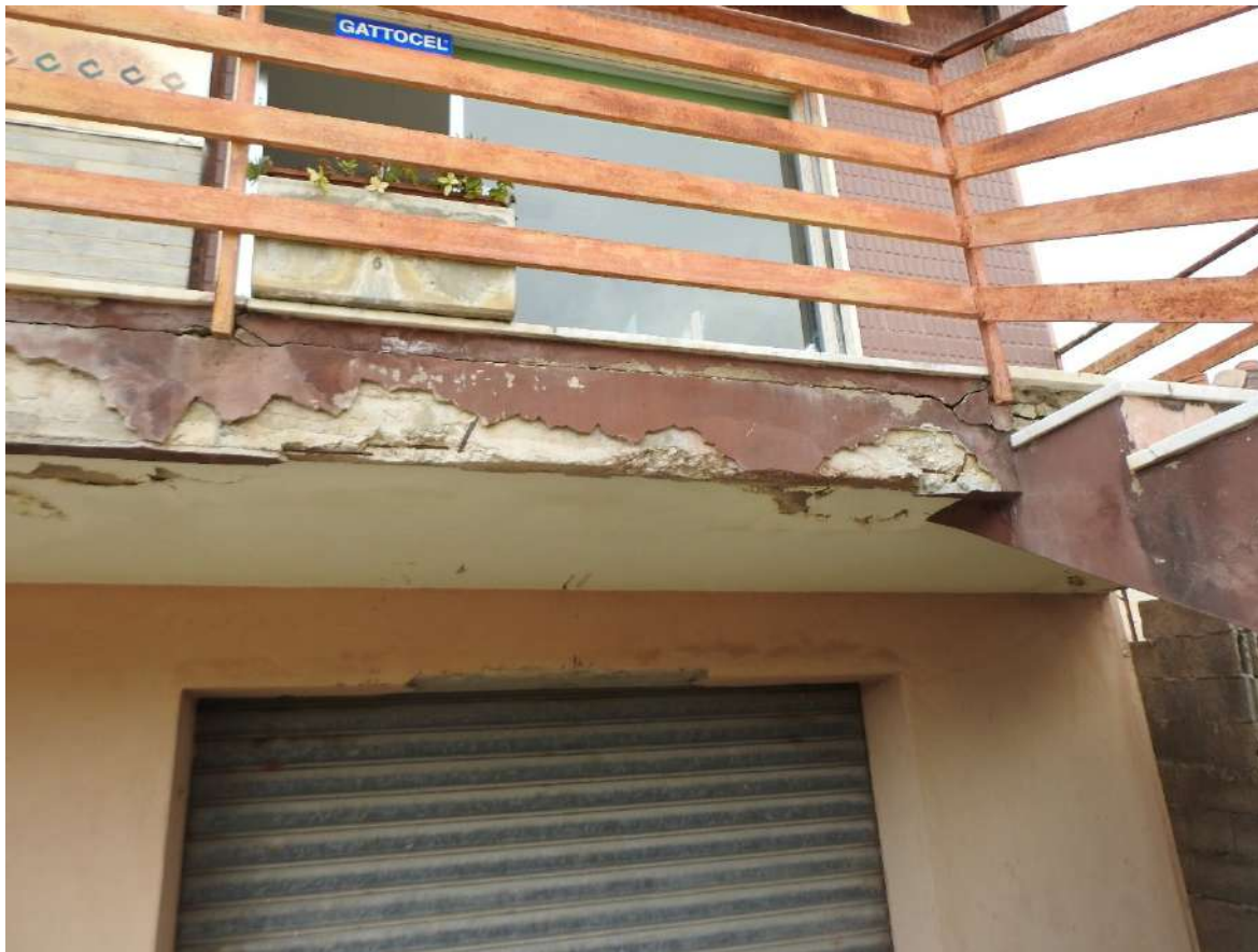
Figura 51 - Immobile 2 (negozio), degrado calcestruzzo balconata
