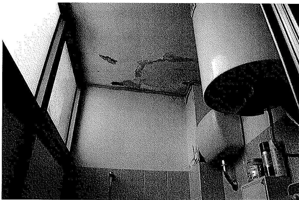
Perdita idrica impianto sovrastante
