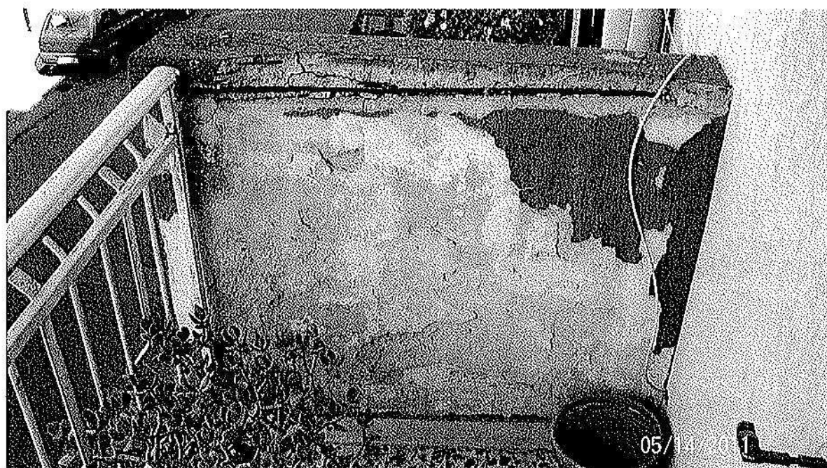
Degrado parapetto balcone
