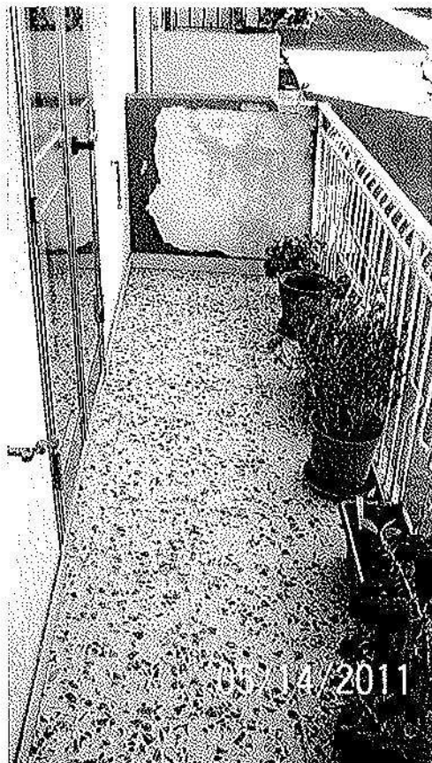
Degrado parapetto e balcone
