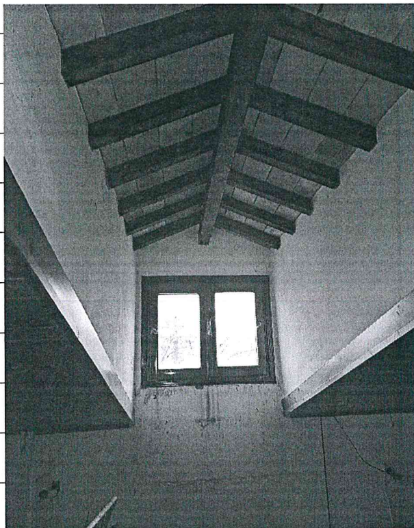
Figura 9 Sopraelevazione non conforme
