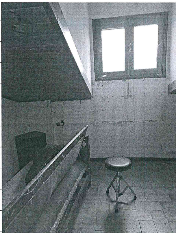
Figura 6 Sopraelevazione non conforme
