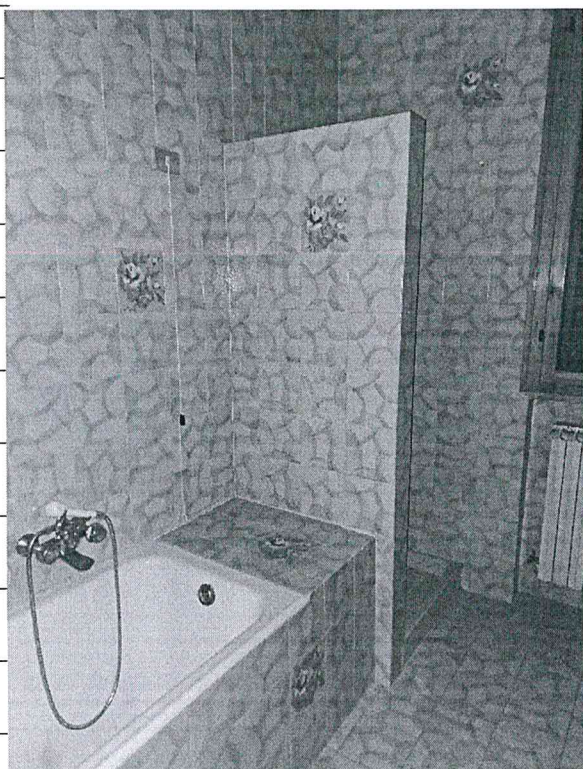
Figura 10 Bagno non conforme
