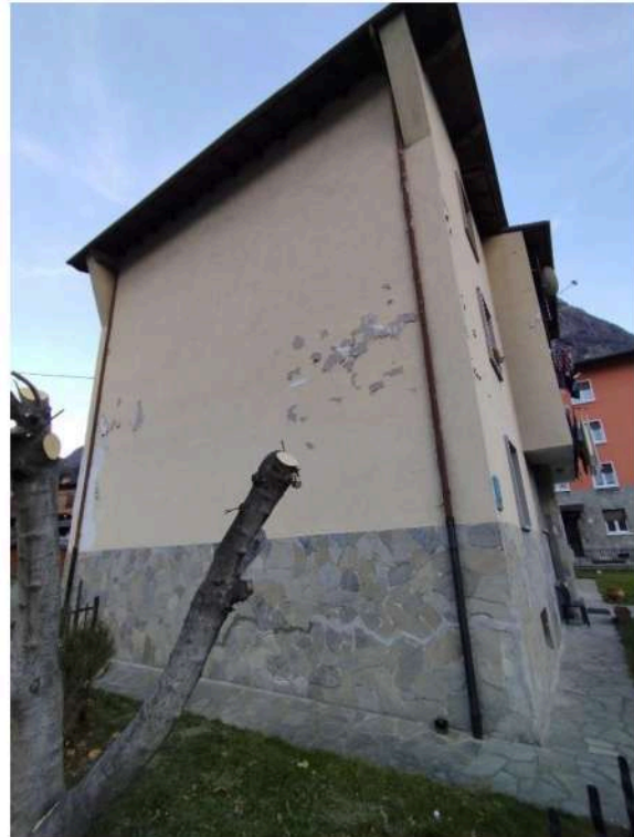
parte ovest degradata
