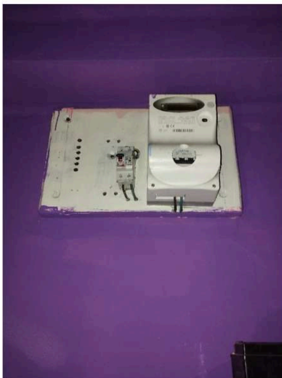
contatore energia elettrica con sezionatore
