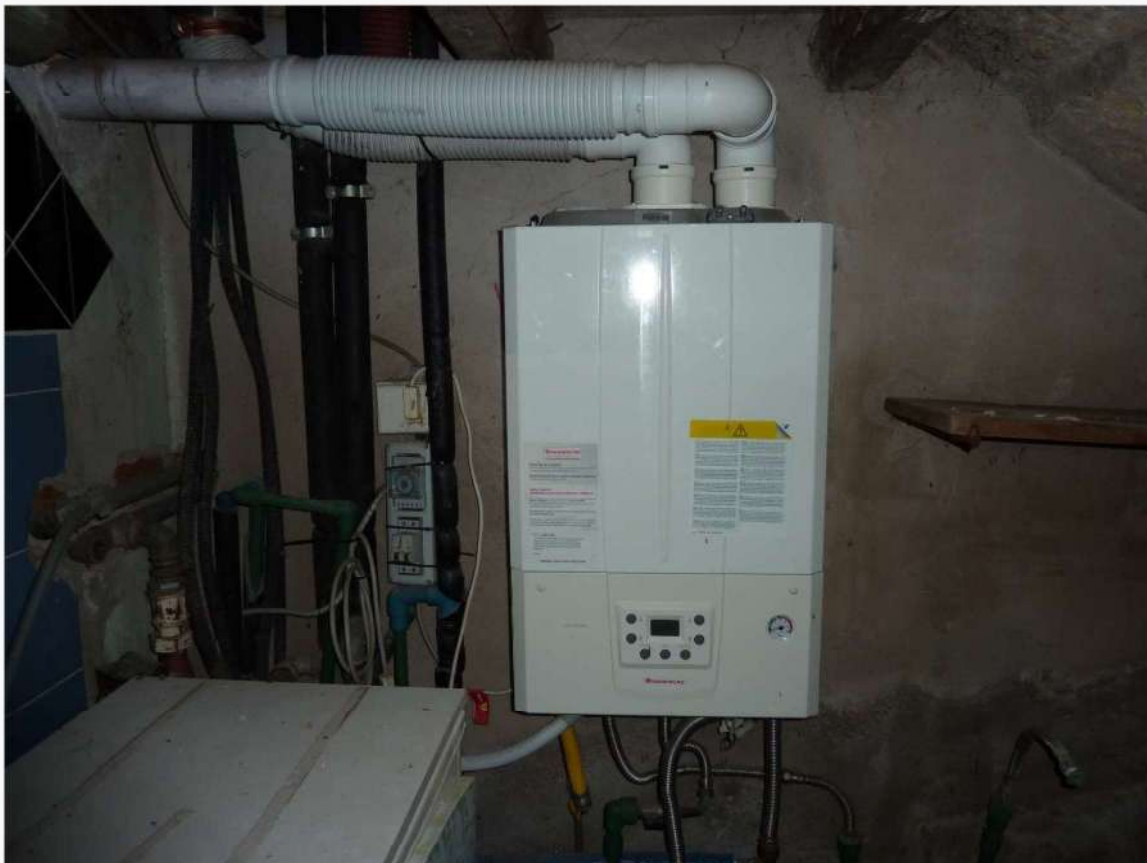
FOTO 9 _ VISTA INTERNA – DETTAGLIO CALDAIA SOTTOSCALA – PIANO TERRA
