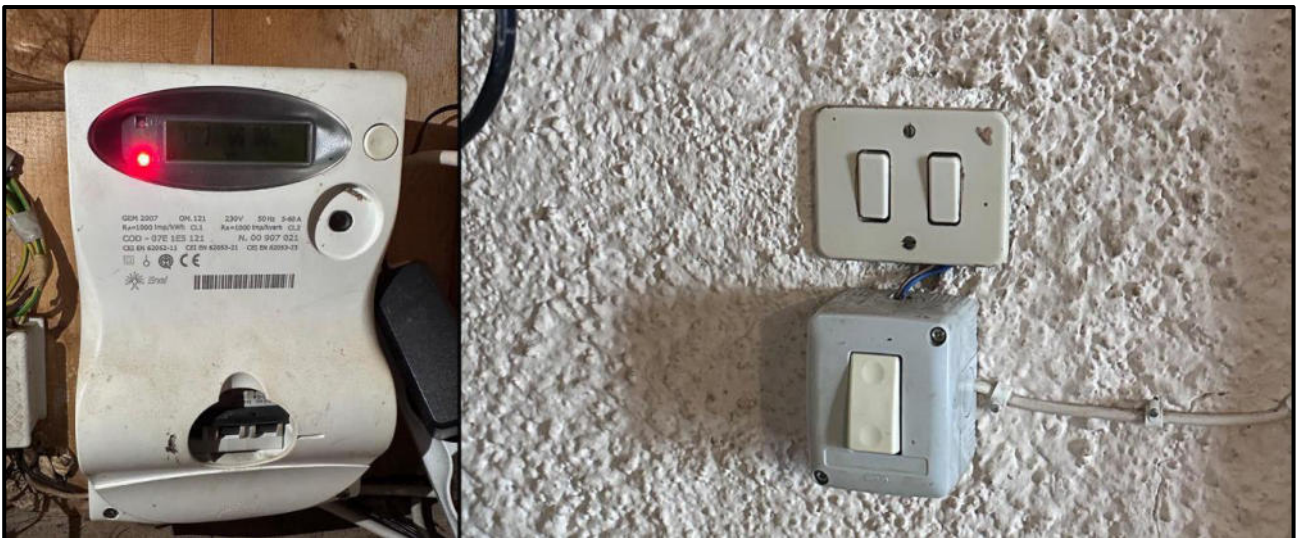
Impianto elettrico: punto di fornitura con alloggiamento contatore
