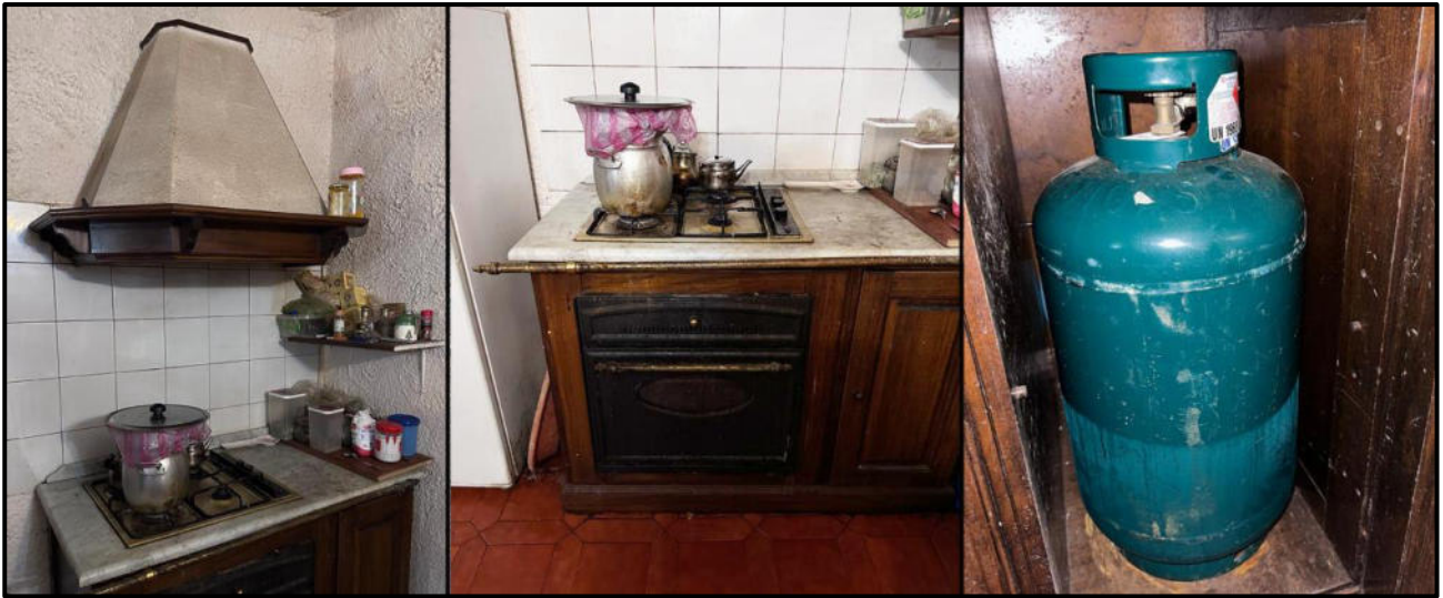
Impianto gas: alloggiamento bombola GPL in cucina
