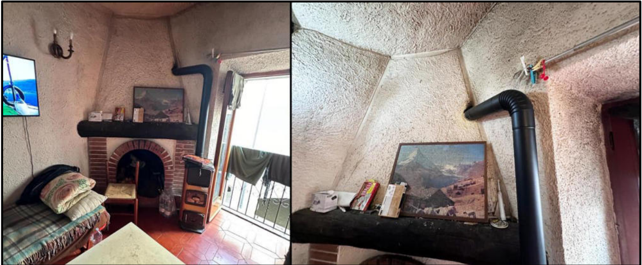
Impianto di riscaldamento: camino a legna
