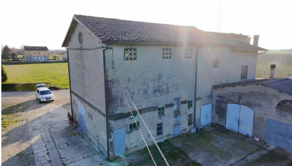
9) Vista aerea da drone, con evidenza della mancato inserimento fasciatura in acciaio.
