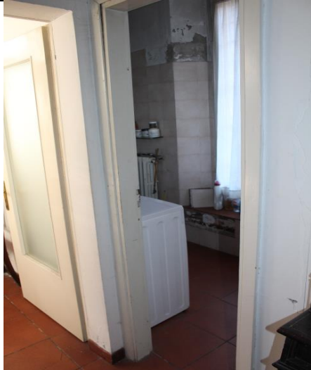
BAGNO – SI NOTANO SEGNI DI UMIDITA'
