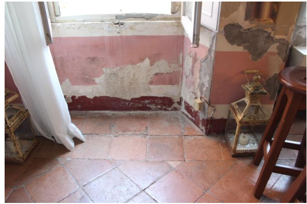
PARTICOLARE DEGLI AMMALORAMENTI MURARI
