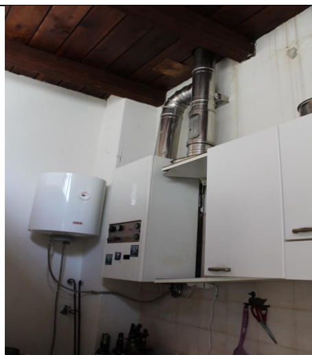
PARTICOLARE CANNA DI ESPULSIONE FUMI DELLA CALDAIA. SI NOTANO INFILTRAZIONI D'ACQUA DAL SOFFITTO
