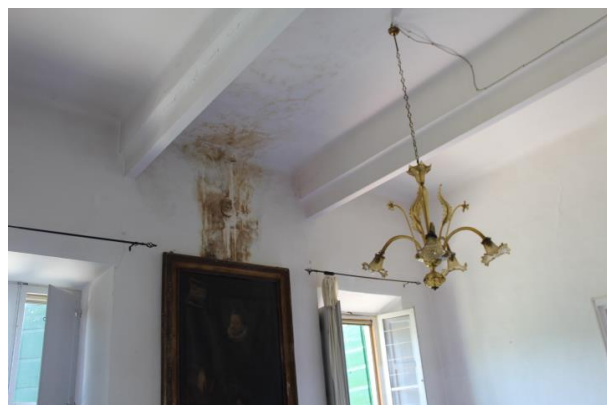
PARTICOLARE INFILTRAZIONI D'ACQUA DALLA COPERTURA
