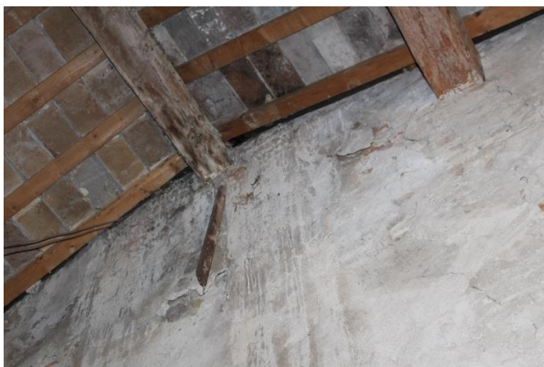
PARTICOLARE INFILTRAZIONI D'ACQUA DALLA COPERTURA
