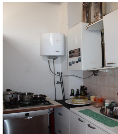
CUCINA; PARTICOLARE BOILER E CALDAIA NON FUNZIONANTE
