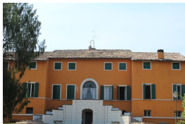
PARTICOLARE DELLA COPERTURA CHE NECESSITA DI INTERVENTI URGENTI, VISTE LE INFILTRAZIONI D'ACQUA
