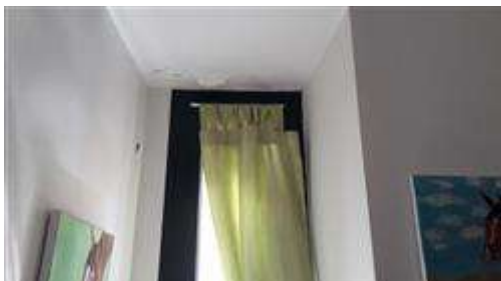
EFFLORESCENZA ED ESFOLIAZIONE DELLA TINTEGGIATURA
