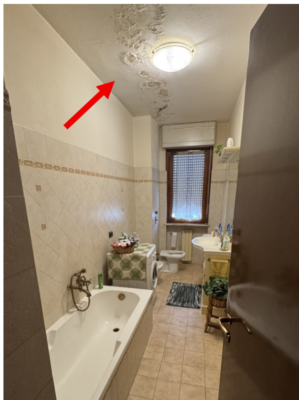
Foto 16: Il bagno (dettaglio: infiltrazioni).
