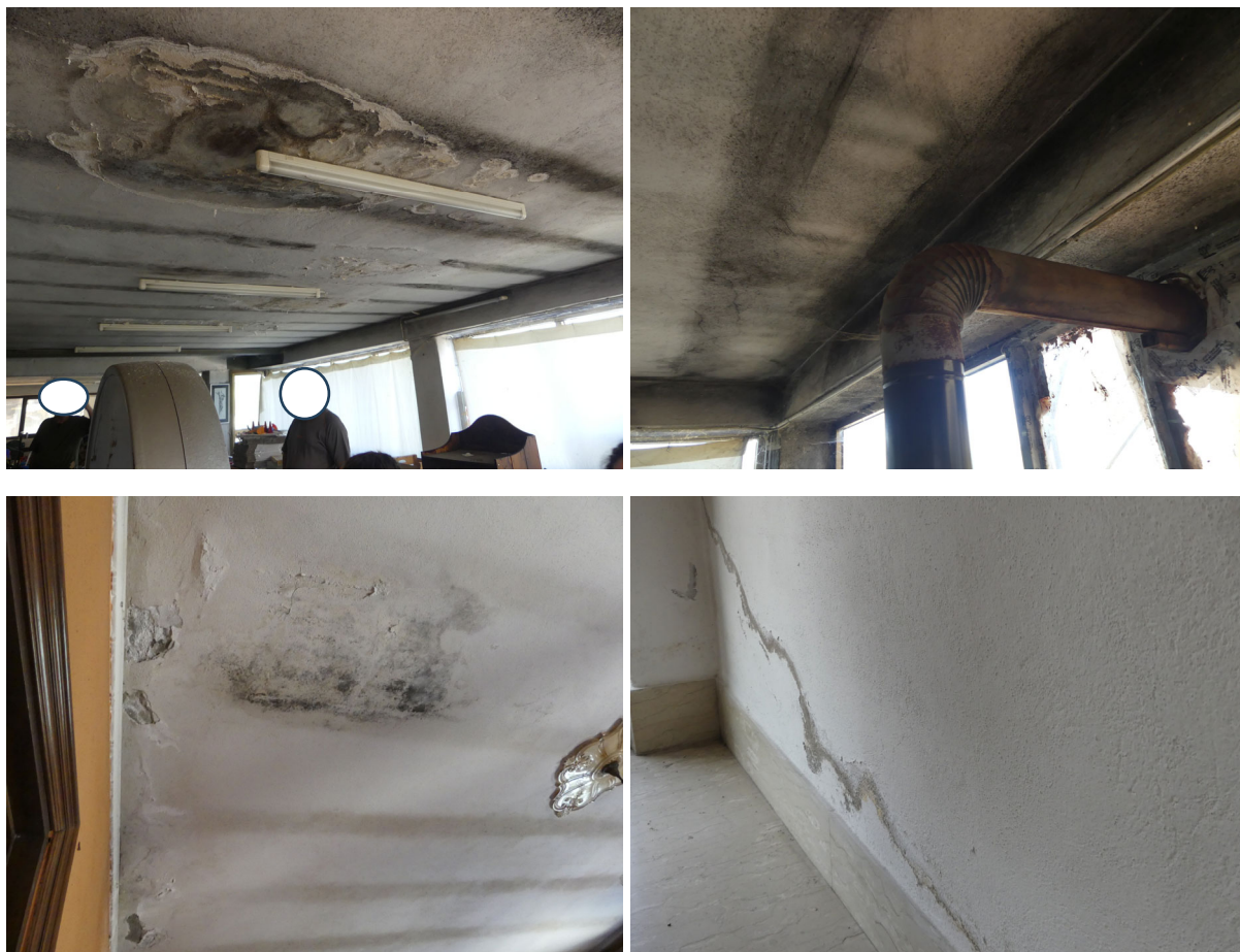
Segni di infiltrazione
