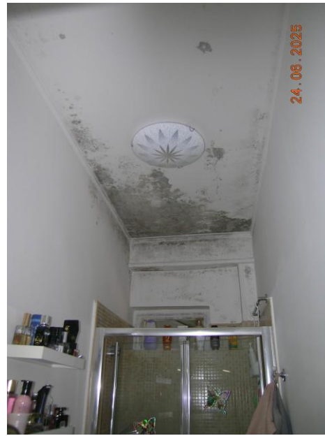
Foto 16 - wc doccia - macchie di muffa sul soffitto in corrispondenza della doccia
