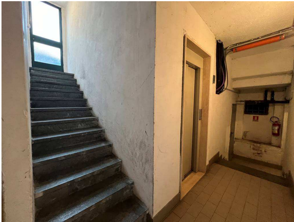
Fotografia n. 30 – Vista della rampa di scale (che sbarca in cortile) e dell'ascensore (che sbarca ai piani), che conducono al piano interrato cantine
