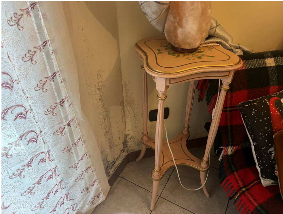
Fotografia n. 18 – Particolare delle muffe presenti solo sull'angolo destro della porta finestra, che si apre sul balcone del locale ingresso/soggiorno-pranzo/angolo cottura, per mancanza di riscaldamento
