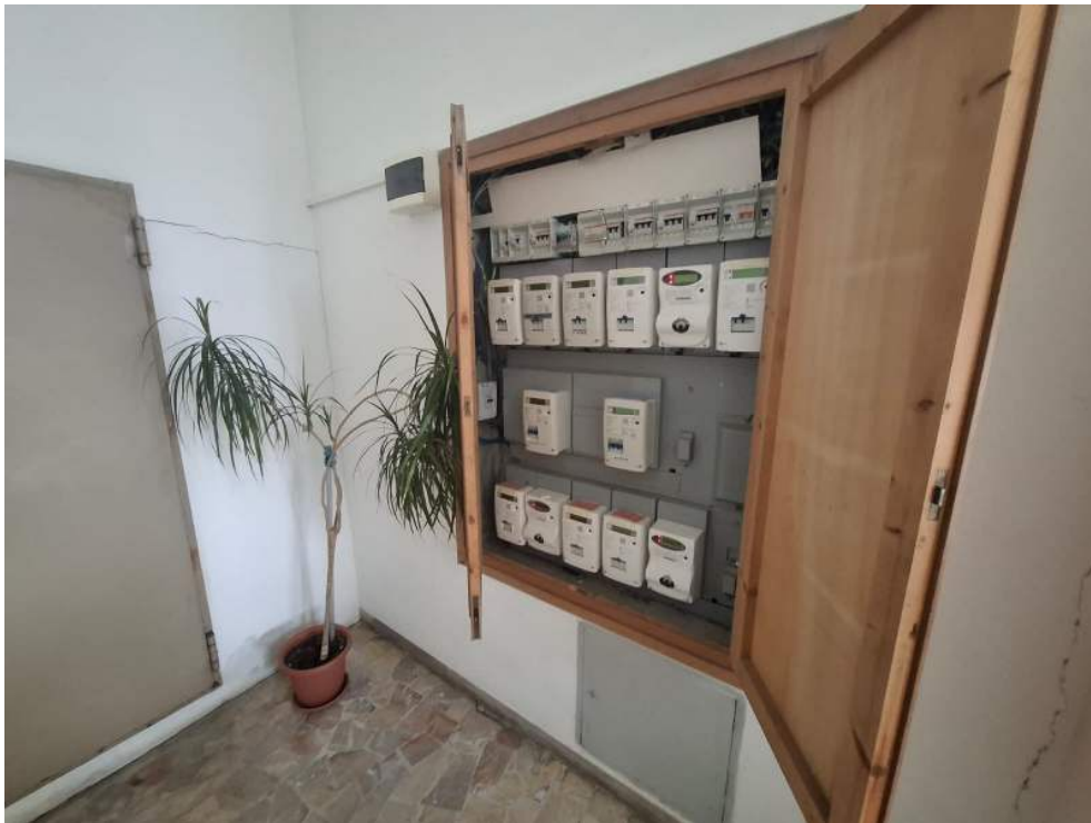
FOTO 4 Contatori ENEL nell'androne di ingresso del vano scala
