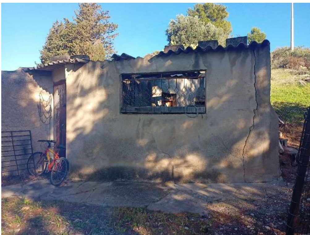
Fotografia 46 – Prospetto magazzino. Bene 4 – Magazzino p.lla n. 1560 Lotto UNICO – Imm. identif. al N.C.T. del Comune di Termini Imerese (PA), fg. n.57, part.lle nn. 1557 – 1559 – Imm. identif. al N.C.E.U. del Comune di Termini Imerese (PA), fg. n.57, part.lle nn. 1558 – 1560.
