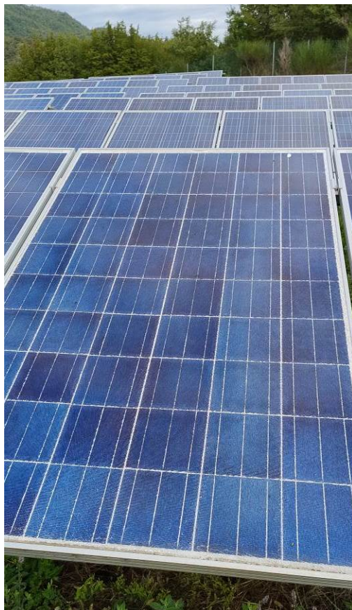
FOTO 5 Pannello fotovoltaico non funzionante
