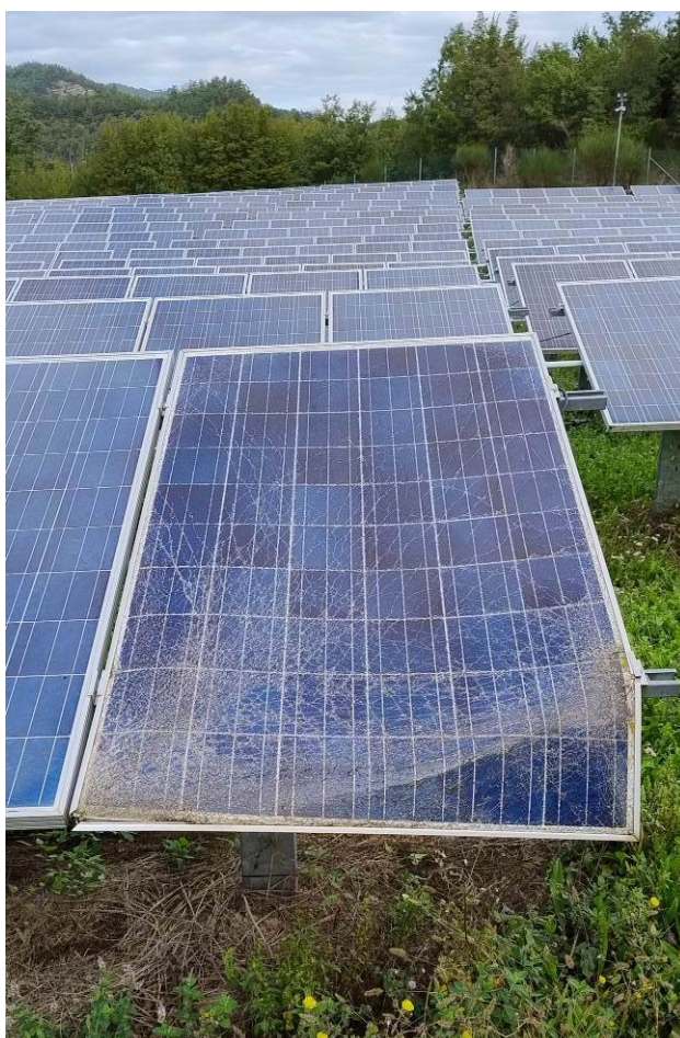
FOTO 6 Pannello fotovoltaico non funzionante
