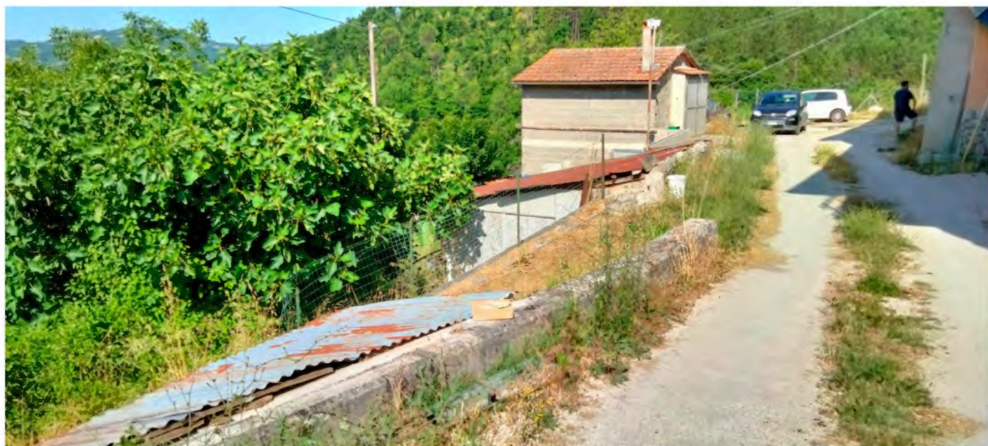
Foto 25 – Corte esterna – Particella 706 con annessi abusivi
