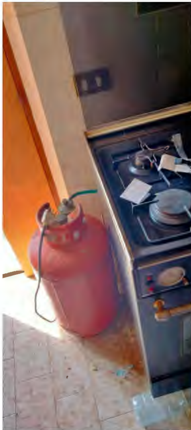
Foto 21 – Uso di bombole di propano per cucinare – PT, PP
