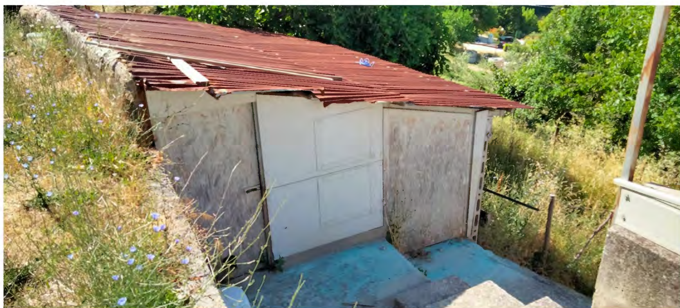
Foto 26 – Corte esterna – Particella 706 con annessi abusivi
