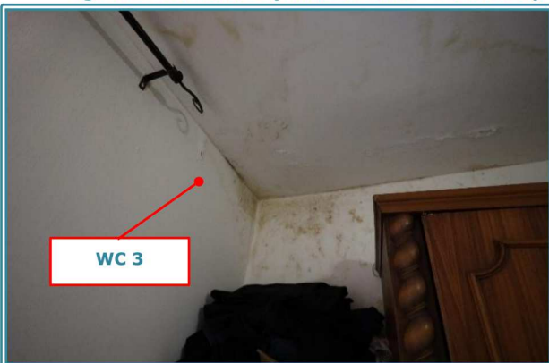
Figura 37 Ammaloramenti presenti nella Camera 3
