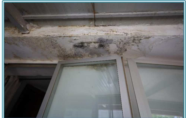
Figura 30 Infiltrazione (Piano Secondo - Sottotetto)
