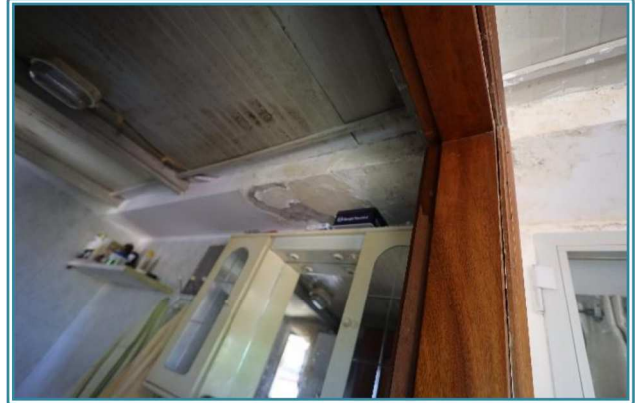
Figura 34 Infiltrazione presente nel WC 4
