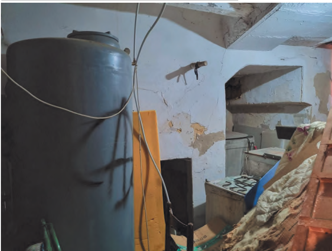
Foto 5. Serbatoio idrico in PVC e serbatoio in eternit
