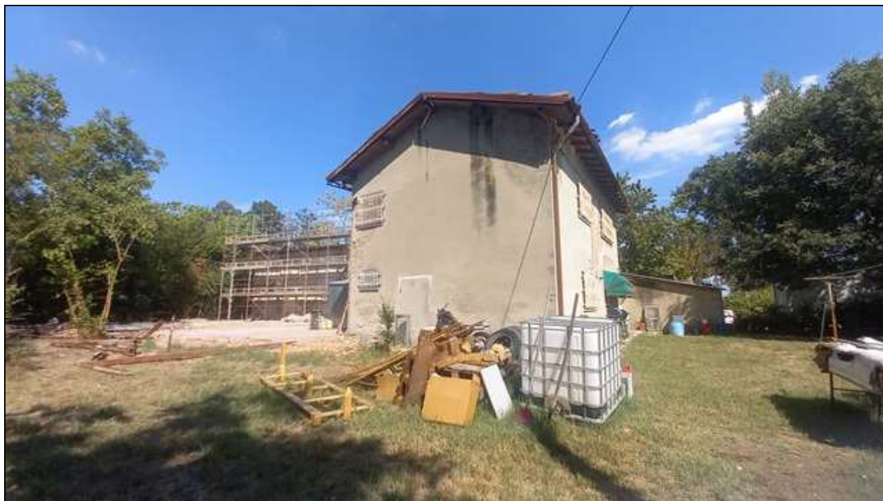
Foto 5: Porzione del fabbricato inagibile (sub. 1 parte) – Prospetto Ovest
