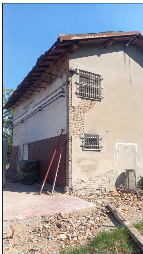
Foto 6: Porzione del fabbricato inagibile (sub. 1 parte) – Prospetti Ovest e Nord
