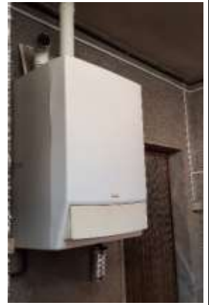
Foto 37 Particolare caldaia P. Semint.
