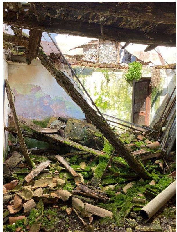
vista interna della stanza ingresso al piano terra con primo solaio in legno crollato
