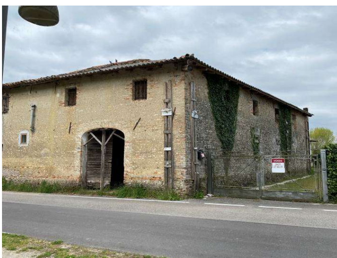
vista lato Nord-Est di proprietà terzi confinante con particolari pericolanti
