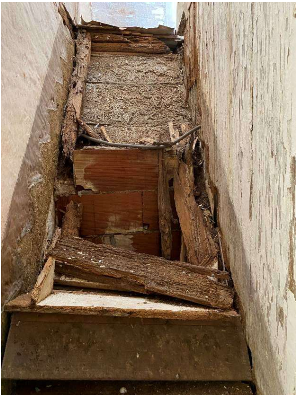
vista scala interna al piano terra crollata con primo piano non accessibile
