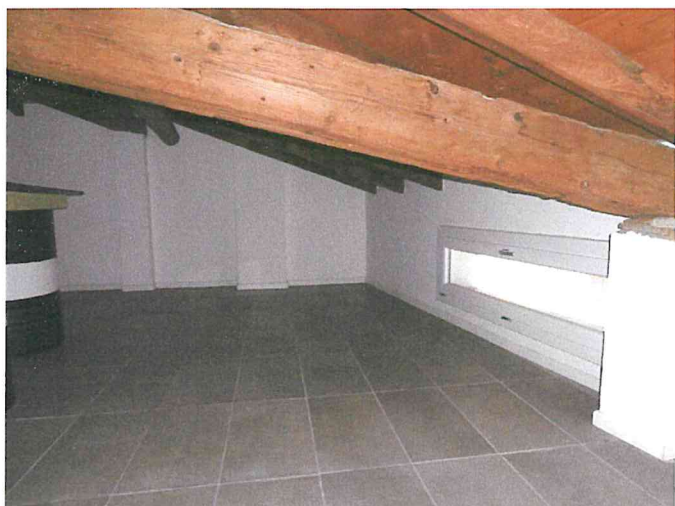
Foto 43 Solaio angolo S-O.JPG
