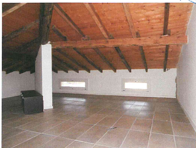
Foto 47 - Solaio angolo N-E.JPG
