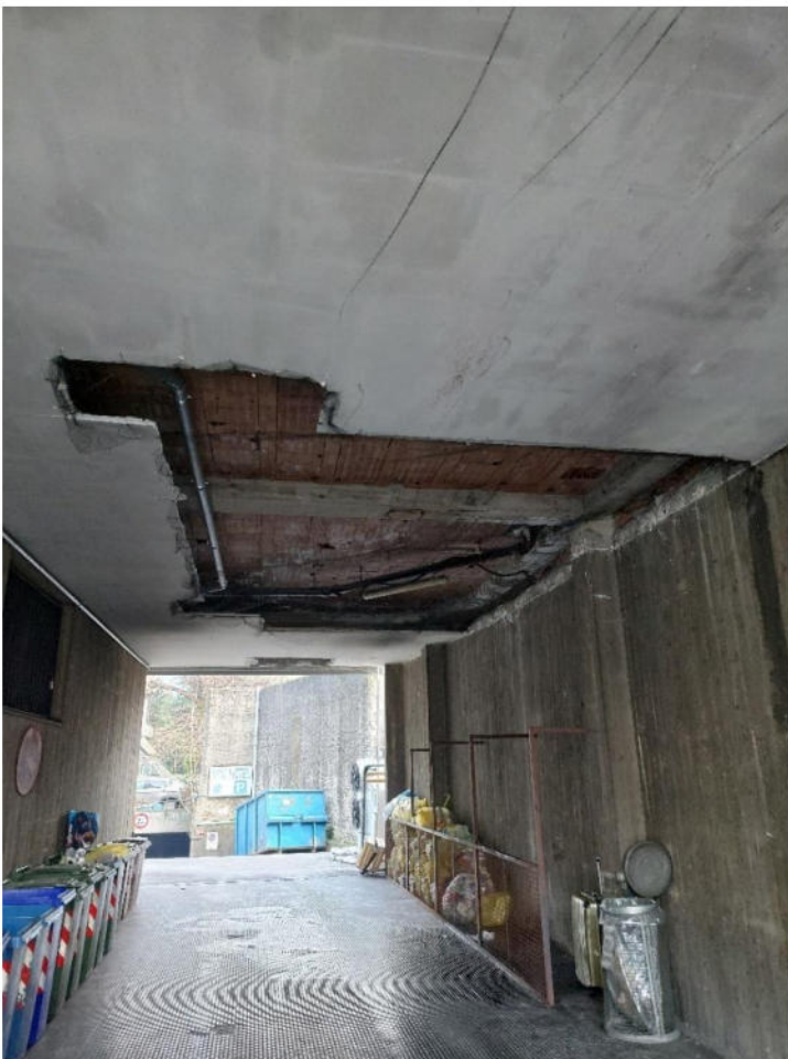
Figura 6 - Vista del tunnel di ingresso ai box sottostanti (in evidenza sul soffitto la rottura eseguita per la riparazione della perdita d'acqua dall'appartamento sovrastante)
