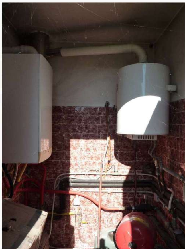
FOTO 31 _ VISTA INTERNA – CENTRALE TERMICA SUB 7 – PIANO TERRA
