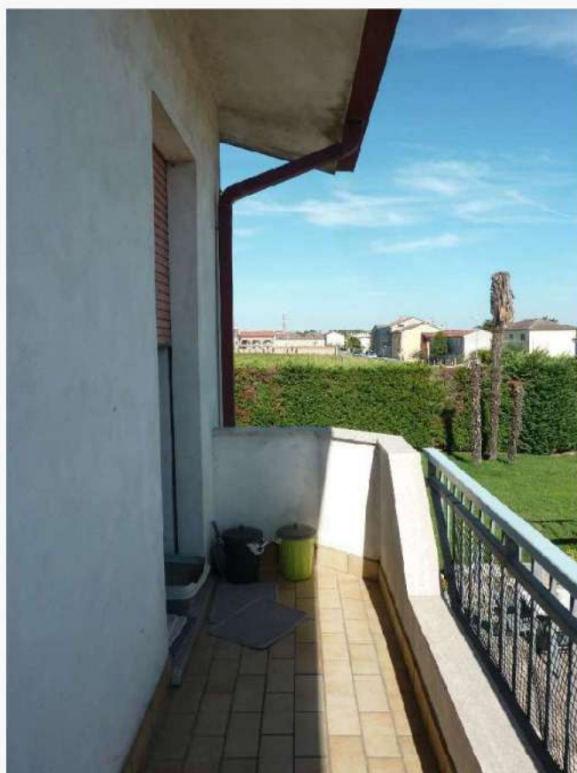
FOTO 21 _ BALCONE APPARTAMENTO SUB 6 – PIANO PRIMO
