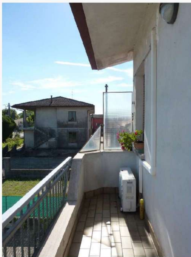
FOTO 20 _ BALCONE APPARTAMENTO SUB 6 – PIANO PRIMO
