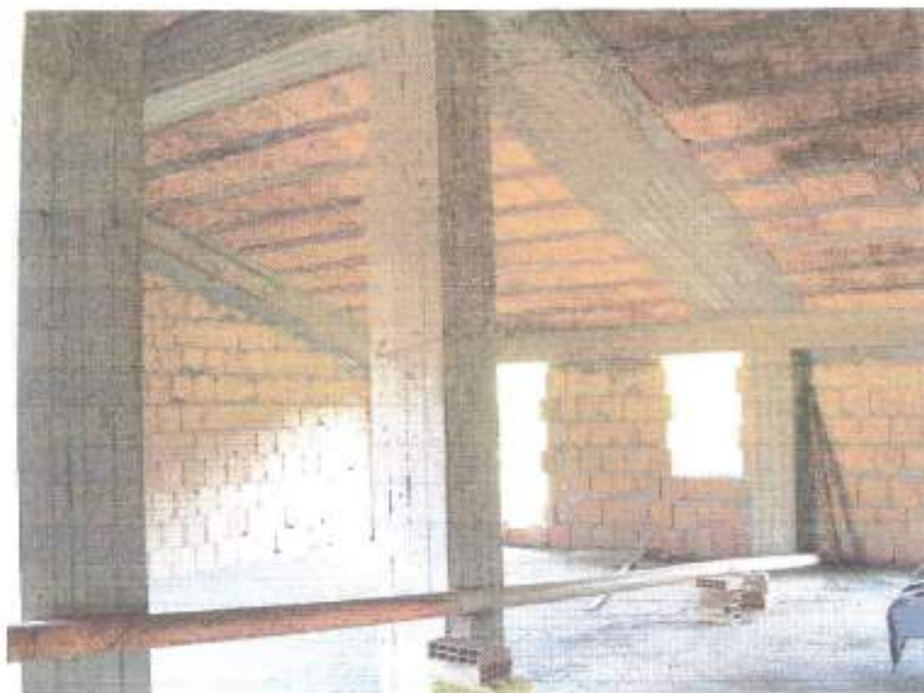
Figura 8 vista interna sub 12
