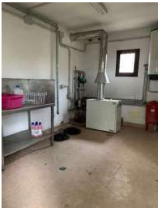
LOCALE CALDAIA SUB.2 CON IMPIANTO IDRAULICO
