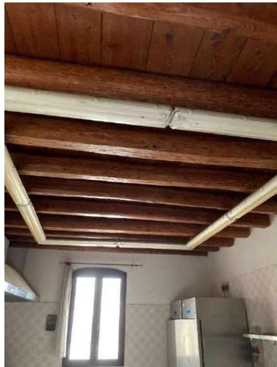
DETTAGLIO SOFFITTO CUCINA
