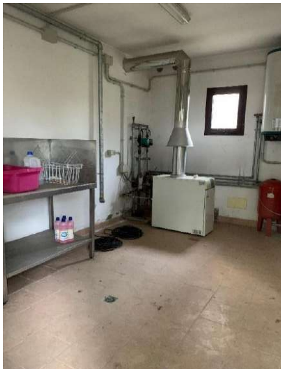
LOCALE CALDAIA SUB.2 CON IMPIANTO IDRAULICO
