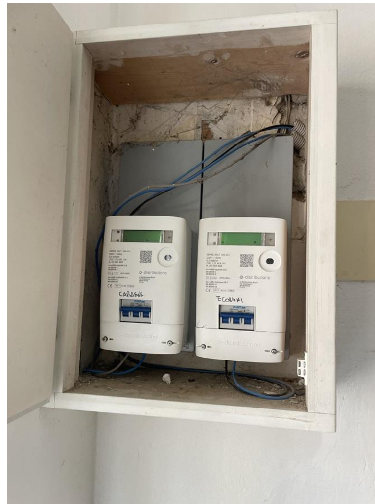
40) C.F. Fg.23 p.IIa 3469 sub.6 – Particolare dell'ubicazione del contatore dell'impianto elettrico
