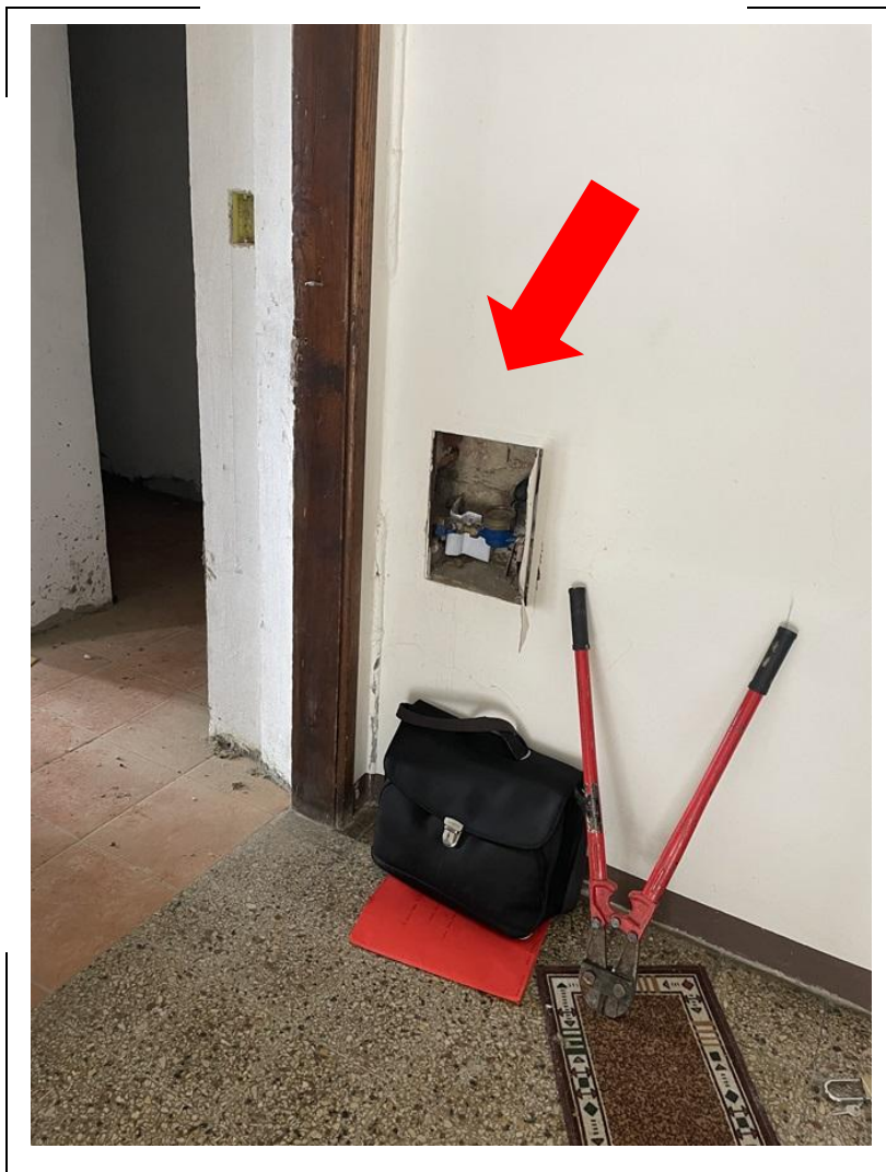
38) C.F. Fg.23 p.la 3469 sub.6 – Particolare dell'ubicazione del contatore dell'impianto idrico
