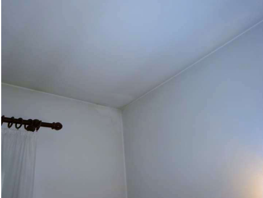
INFILTRAZIONI SUL SOFFITTO PRIMO PIANO
