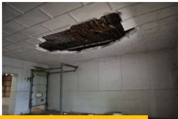
Capannone centrale – cella frigorifera priva di impianti, serramenti e con crollo parziale
