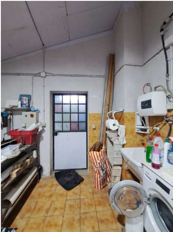
Figura 21- impianti nel locale di sgombero
