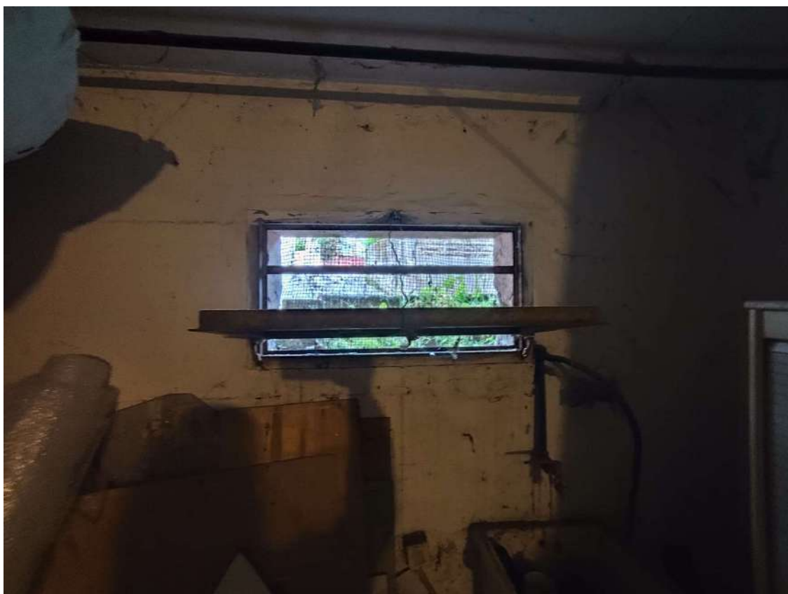
Magazzino P1S – dettaglio della finestra non autorizzata
