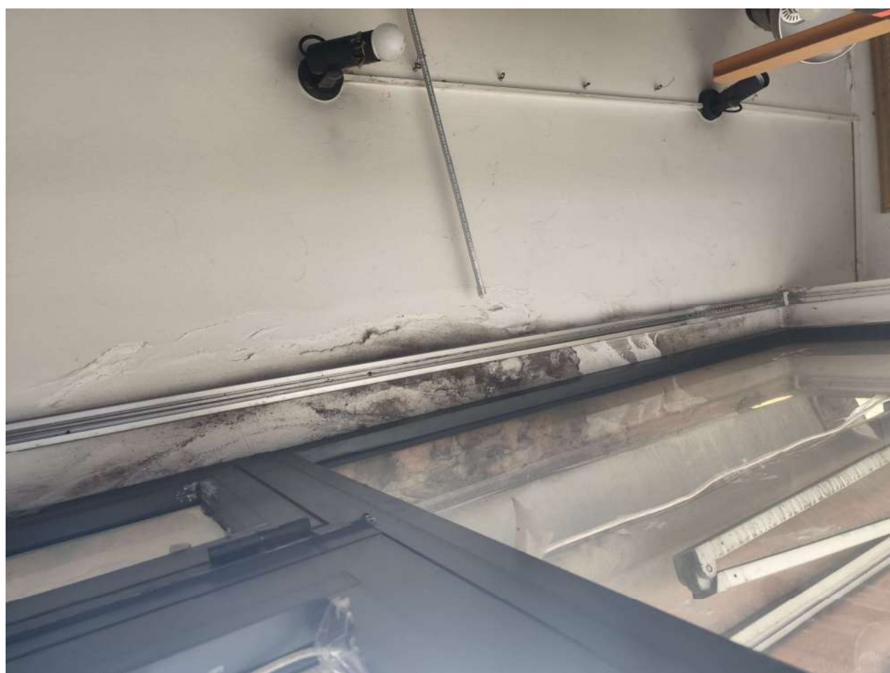
Negozio PT - Spazio espositivo – dettaglio intonaco danneggiato da umidità
