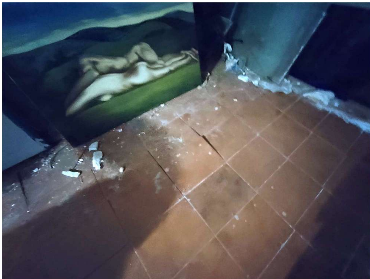
Magazzino P1S – dettaglio pavimentazione sollevata
