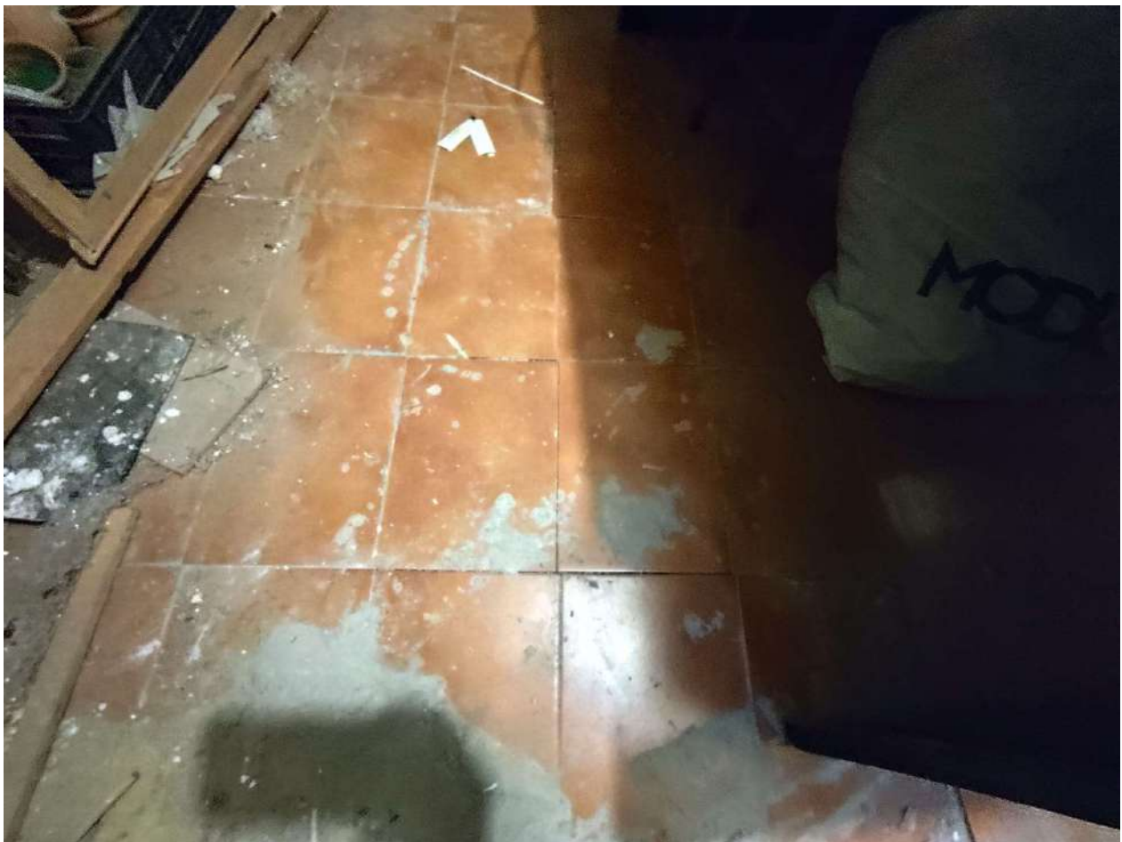
Magazzino P1S – dettaglio pavimentazione sollevata
