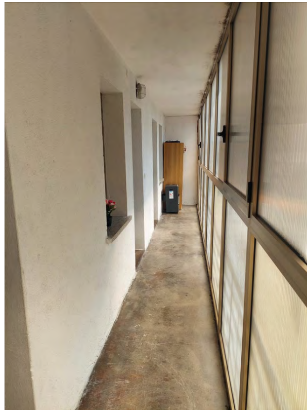
Terrazzo P1 con vetrata da rimuovere
