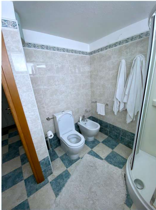
35 - Servizio igienico al piano primo vista sui sanitari
