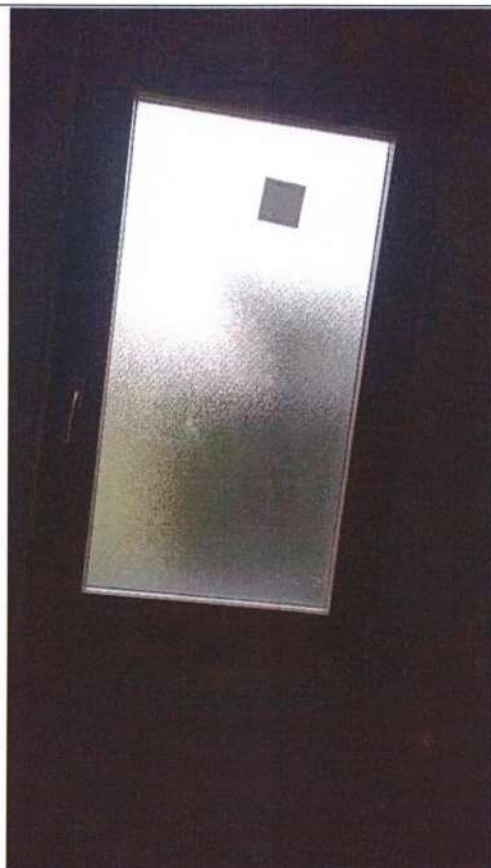
Foto 49 – STANZA OGGETTO DI PIANO CASA, INCOMPLETA. DETTAGLIO INFISSO
