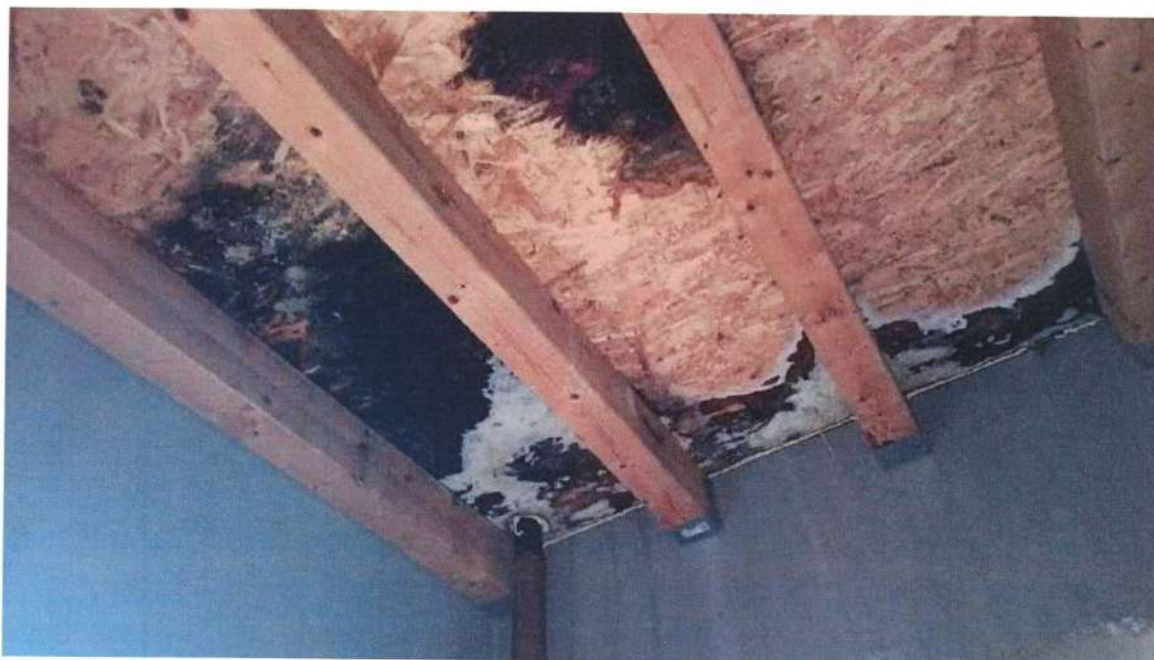
Foto 45 – STANZA OGGETTO DI PIANO CASA, INCOMPLETA (INFILTRAZIONE DALLA COPERTURA)
