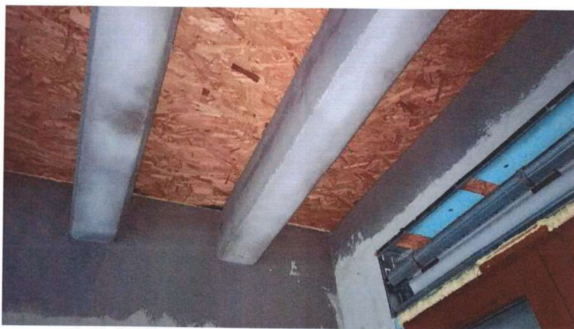
Foto 46 – STANZA OGGETTO DI PIANO CASA, INCOMPLETA. DETTAGLIO COPERTURA
