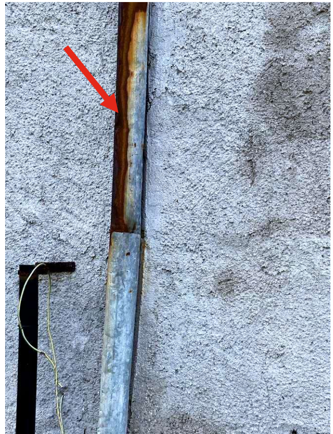
ulteriore vista degrado dello scarico pluviale
