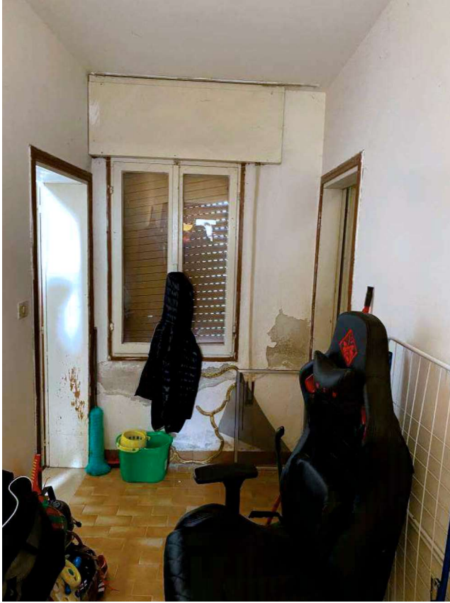
vista degrado intonaco nel disimpegno
