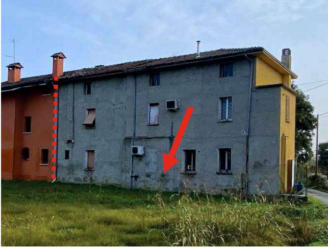
vista degrado del lato ovest con umidità di risalita
