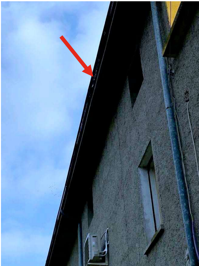
vista degrado delle grondaie
