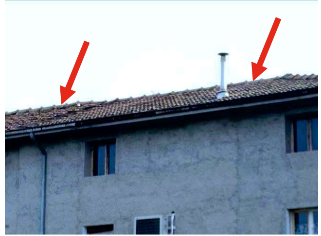
vista degrado del manto di copertura
