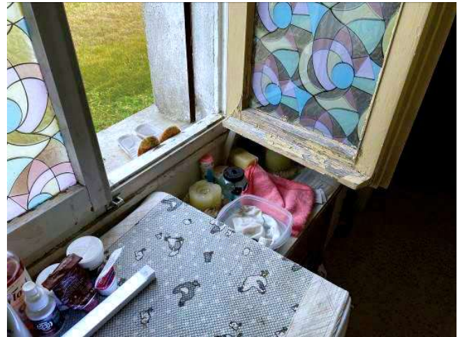
vista degrado delle finestre al primo piano
