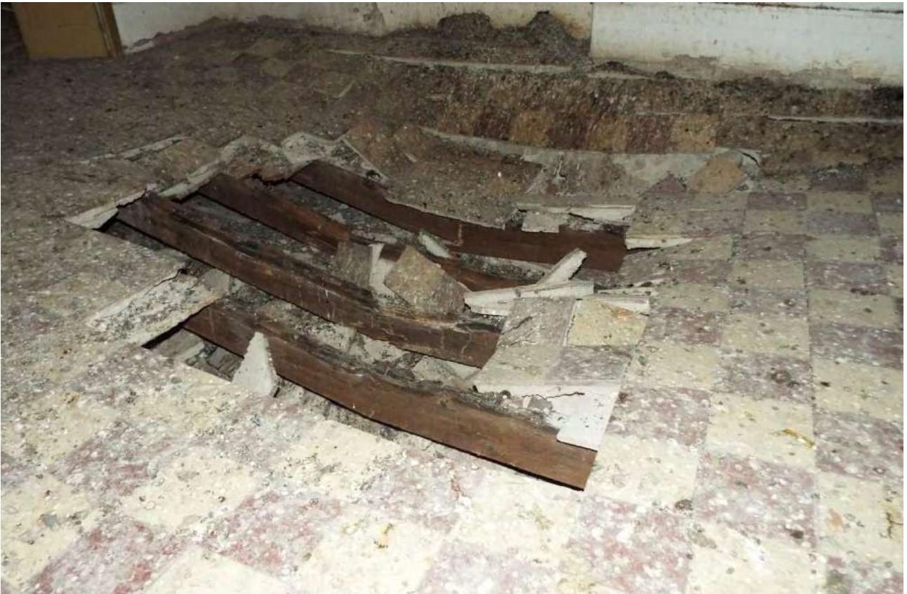
Dettaglio cedimento travi supporto pavimentazione
