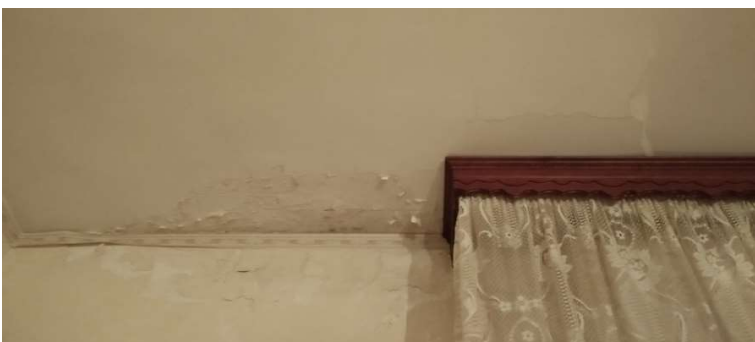
Foto 21. Vano Soggiorno/Pranzo. Degrado intonaco.
