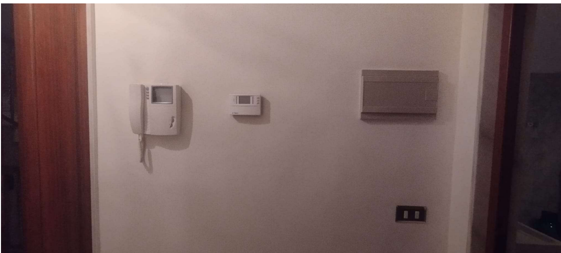
Foto 14. Corridoio. Quadro elettrico, citofono e termostato.
