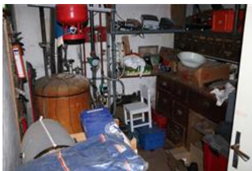
LOCALE CALDAIA COMUNE
