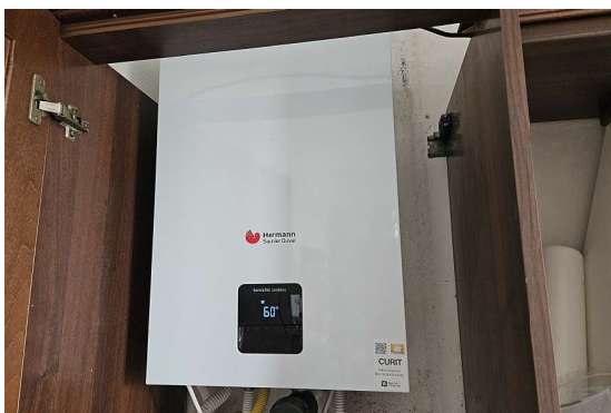
Caldaia a condensazione di recente installazione
