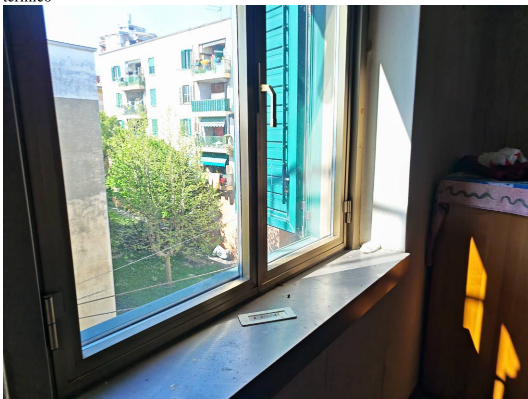
FOTO 41 – stanza da letto dell'alloggio (unità condominiale "8", subalterno catastale 13), particolare del serramento in alluminio e vetro, privo di taglio termico
