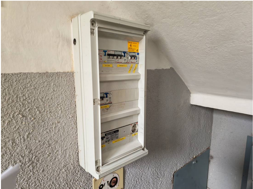
FOTO 23 – Ingresso al piano terra del condominio di Viale Campi Elisi n. 20, Trieste; particolare del quadro elettrico condominiale (luci scale, centralino TV, luce esterna, alimentazione citofono)
