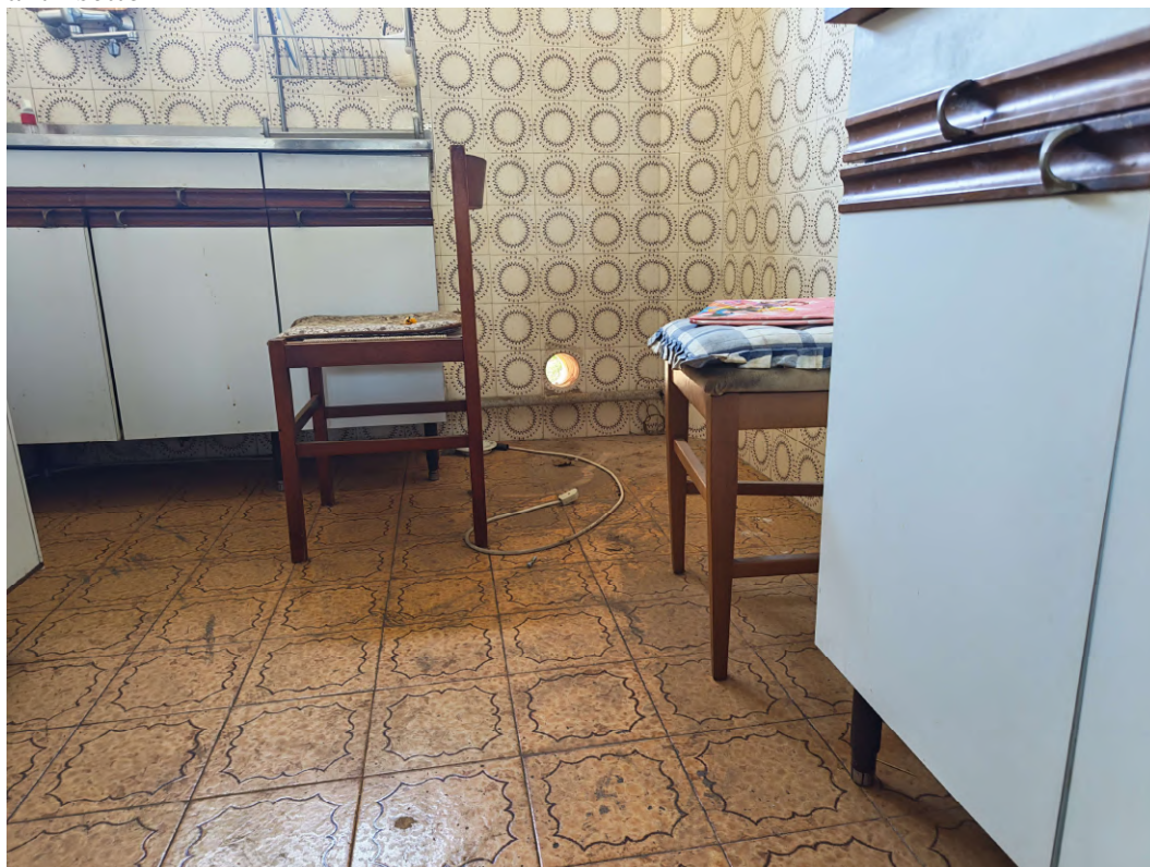
FOTO 75 – cucinino dell'alloggio (unità condominiale "8", subalterno catastale 13): visibile il foro di aerazione permanente, privo di idonea griglia e rete antinsetto
