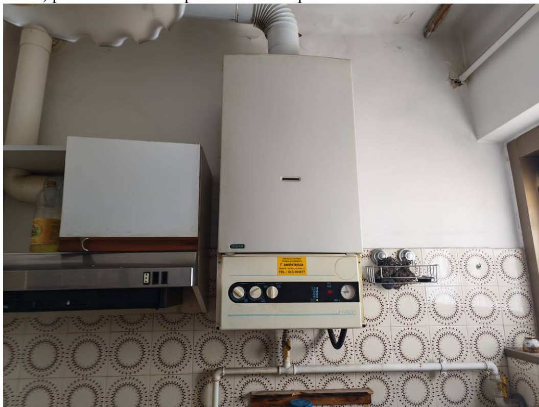
FOTO 69 – cucinino dell'alloggio (unità condominiale "8", subalterno catastale 13), particolare della caldaia a gas metano, marca Ocean, modello Luna 20 i, caldaia murale a gas a camera aperta, con potenza termica di 23,3 kW (20.000 kcal/h) per riscaldamento e produzione di acqua calda sanitaria
