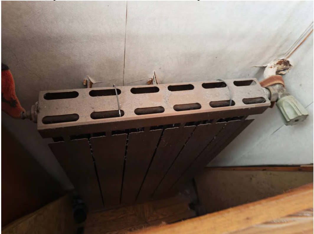
FOTO 43 – stanza da letto dell'alloggio (unità condominiale "8", subalterno catastale 13), particolare del calorifero in alluminio presente
