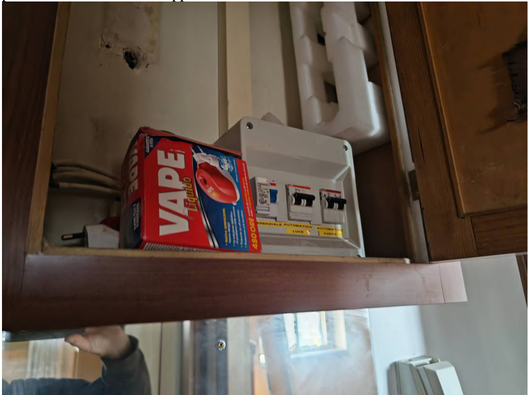
FOTO 37 – Corridoio dell'alloggio (unità condominiale "8", subalterno catastale 13); particolare del quadro elettrico. Il contatore elettrico è ubicato nel porticato al piano terra, all'interno di apposita armadiatura
