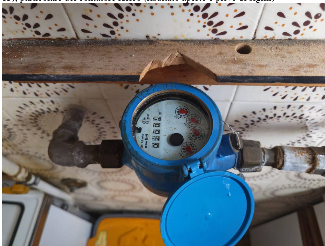
FOTO 72 - cucinino dell'alloggio (unità condominiale "8", subalterno catastale 13), particolare del contatore idrico (risultato aperto e privo di sigilli)
