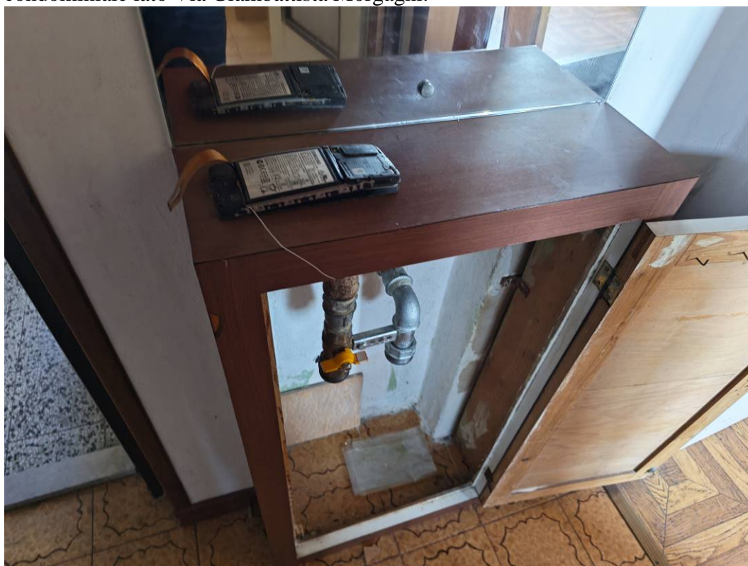
FOTO 36 – Corridoio dell'alloggio (unità condominiale "8", subalterno catastale 13); armadiatura del precedente alloggiamento del contatore del gas metano, dismesso in quanto la nuova linea è stata realizzata esternamente sulla facciata condominiale lato Via Giambattista Morgagni.
