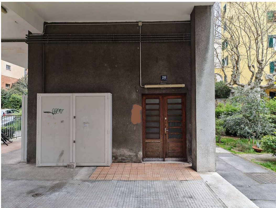
FOTO 12 – Porticato del condominio di Viale Campi Elisi n. 20 (p.c.n. 6133/17 del C.C. di Trieste); particolare del portone di ingresso condominiale. Sulla sinistra si trova l'armadiatura contenente i contatori elettrici.
