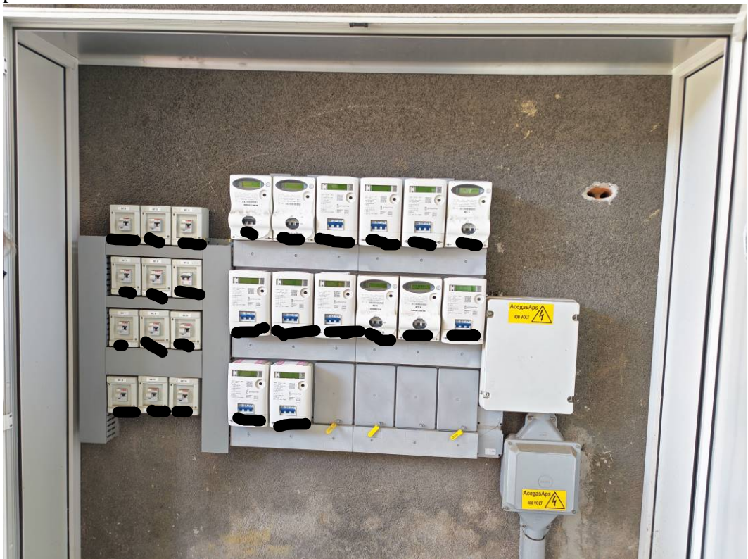
FOTO 20 – Particolare dei contatori elettrici, di cui uno di pertinenza dell’unità condominiale “8” (subalerno catastale 13), collocati nell’armadiatura del porticato. Il contatore risulta chiuso
