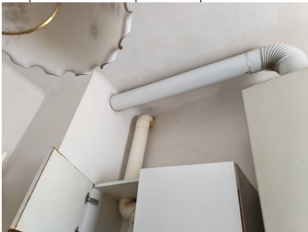
FOTO 68 – cucinino dell'alloggio (unità condominiale "8", subalterno catastale 13), particolare della canna di esalazione dei fumi del piano cottura e della caldaia dell'impianto di riscaldamento e di produzione di acqua calda
