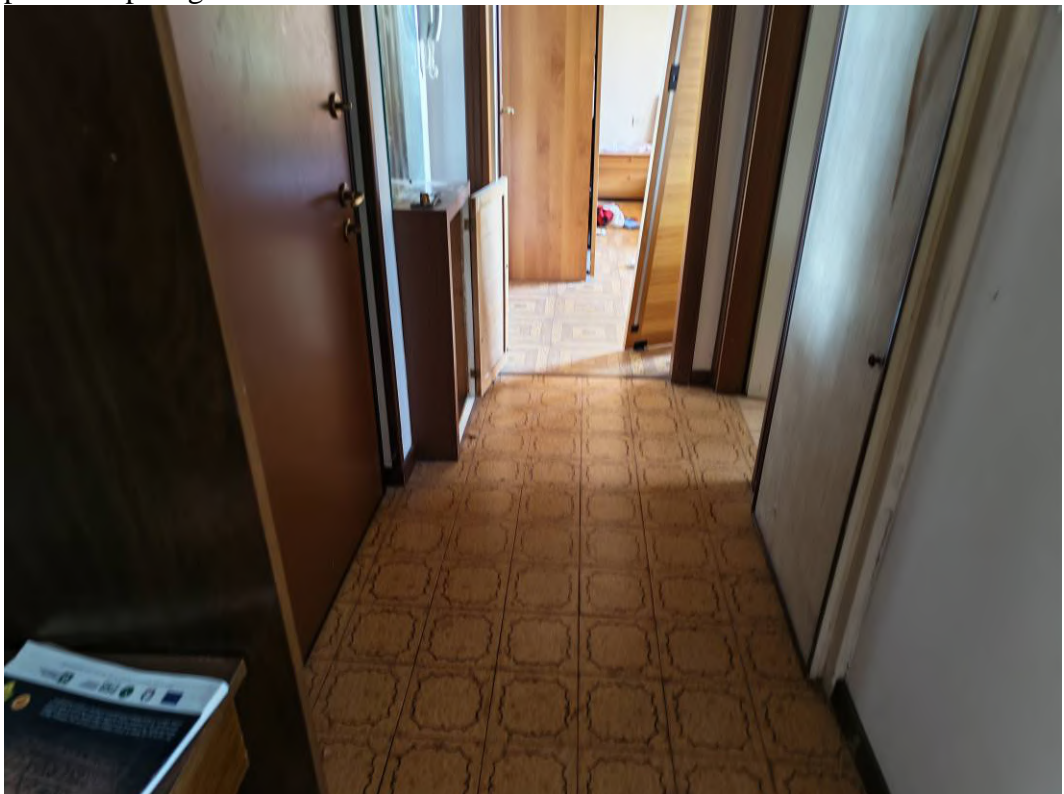
FOTO 32 – Corridoio dell'alloggio (unità condominiale "8", subalterno catastale 13); sulla sinistra il portoncino blindato che consente l'accesso dal pianerottolo del terzo piano, sulla destra il serramento di porta chiuso che consente l'accesso al piccolo ripostiglio/nicchia
