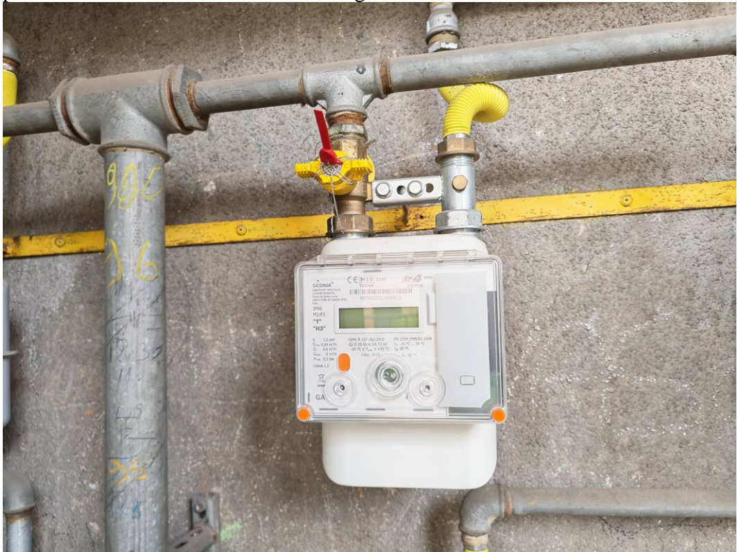
FOTO 19 – Particolare del contatore del gas metano dell’alloggio al terzo piano (unità condominiale “8”, subalerno catastale 13), collocato nell’armadiatura del porticato. Il contatore risulta chiuso e sigillato.
