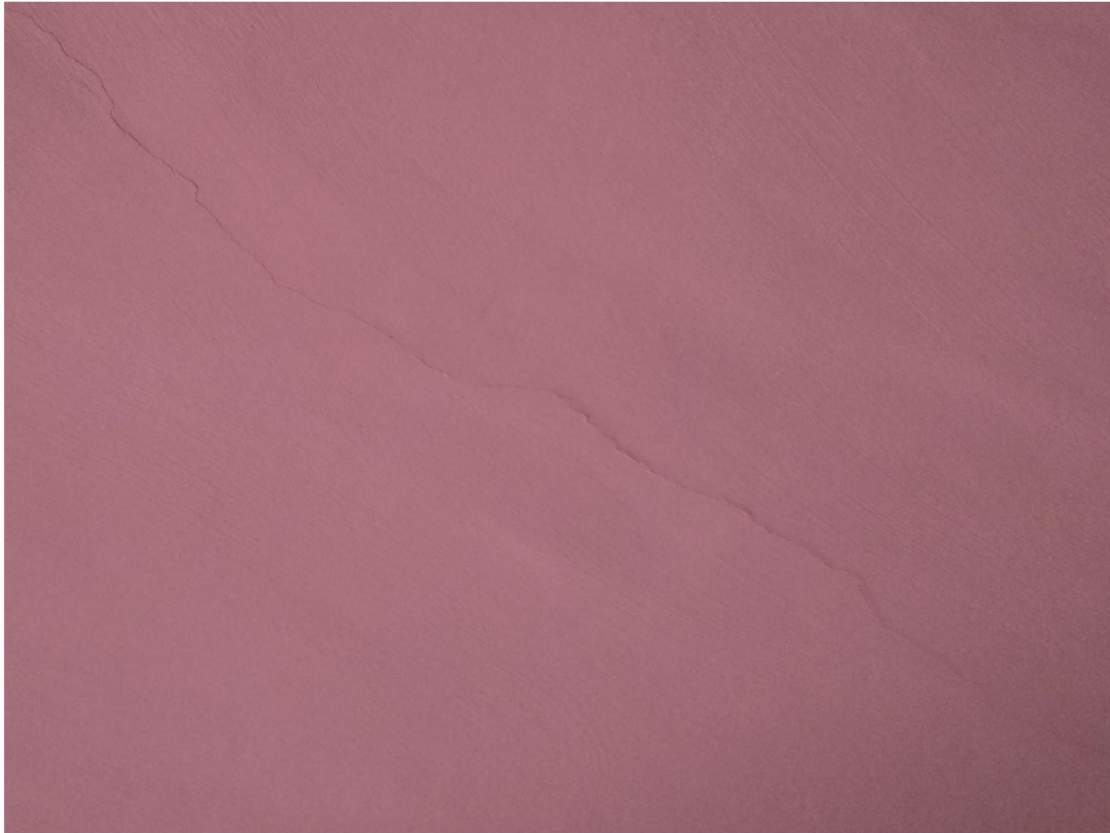
Lesioni sul soffitto
