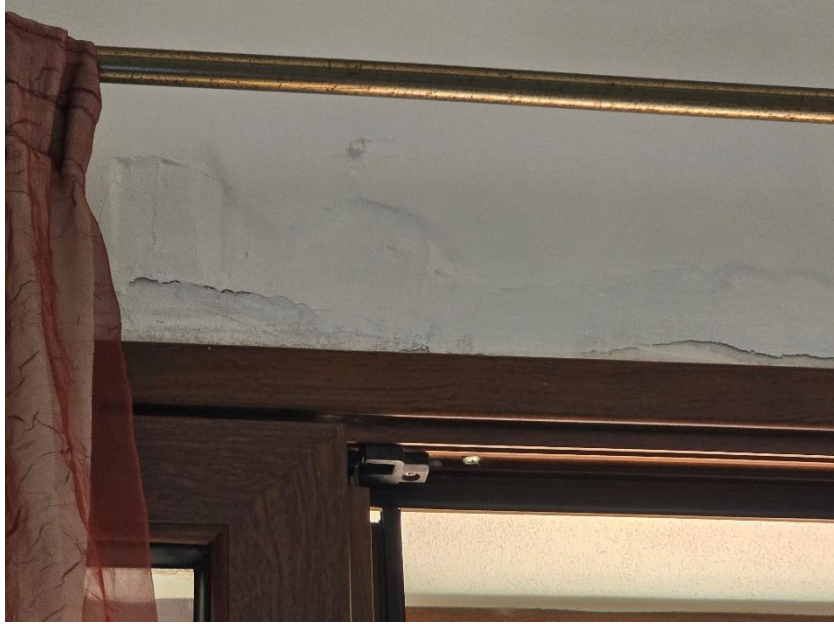
Infiltrazioni lungo gli infissi
