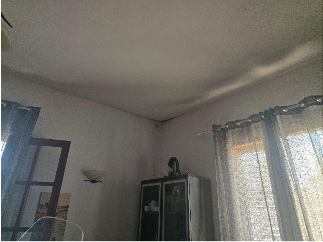
Muffe al soffitto del soggiorno
