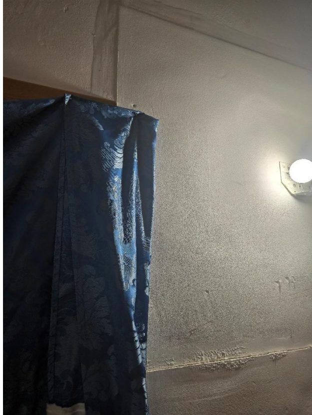
Umidità di risalita
