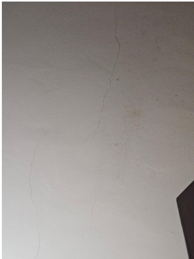
Lesioni lungo le pareti
