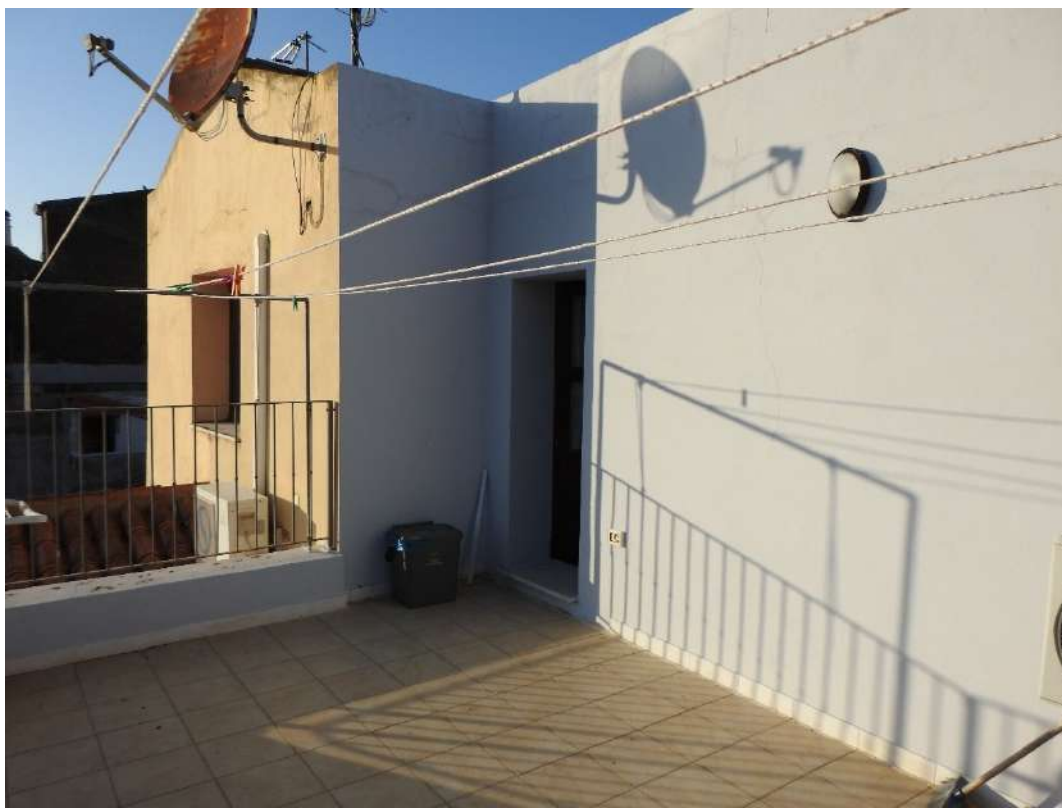
Figura 21 - Terrazza abusiva. Visuale verso porta finestra dell'ultimo pianerottolo
