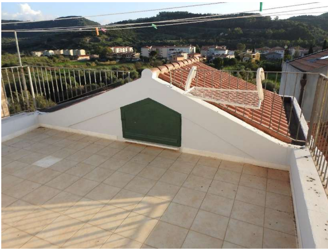
Figura 20 - Terrazza condominiale (abusiva). Visuale dalla porta finestra
