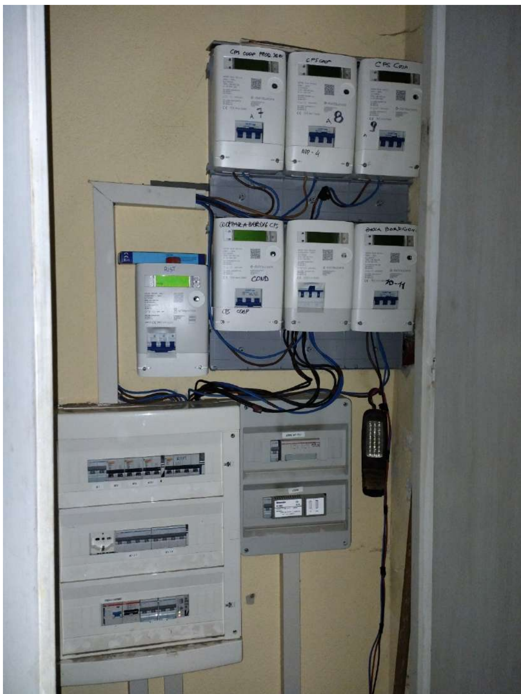
Figura 26 - Androne di ingresso, zona contatore e quadri elettrici/paraelettrici
