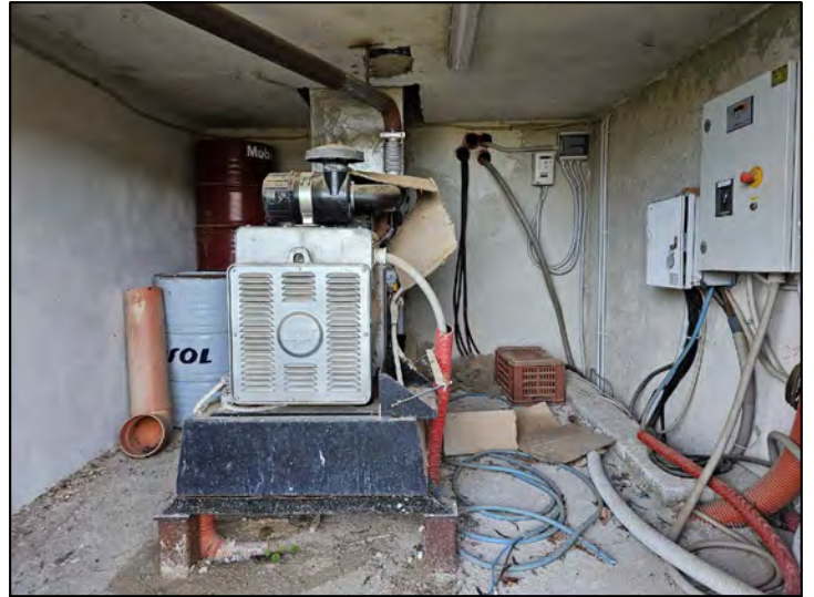
FOTO 137 - Lotto 2 - Corpo Z - Interni piano seminterrato del Fabbricato a 2 livelli sul lato Nord-Ovest del Capannone
