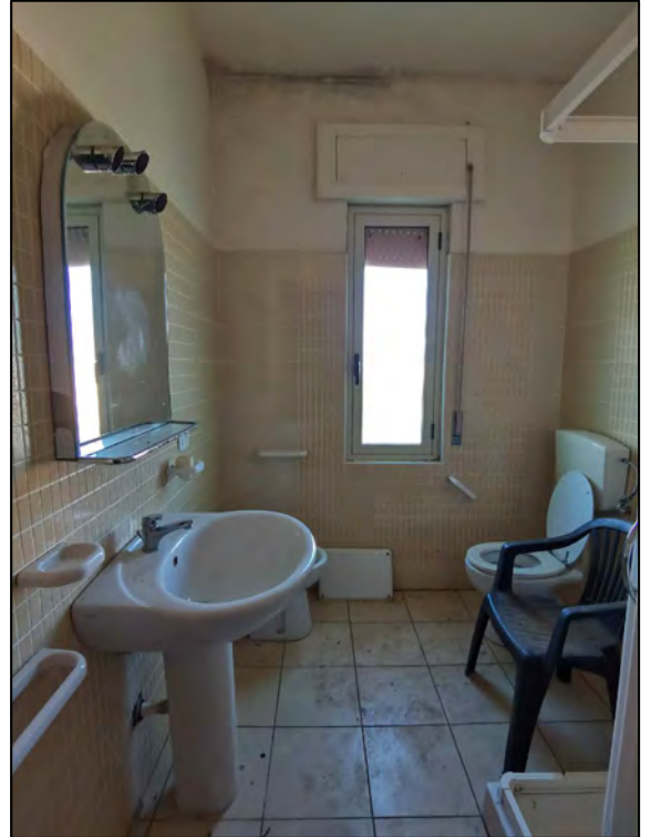
FOTO 93 - Lotto 2 - Corpo Y - Appartamento A (Bagno)
