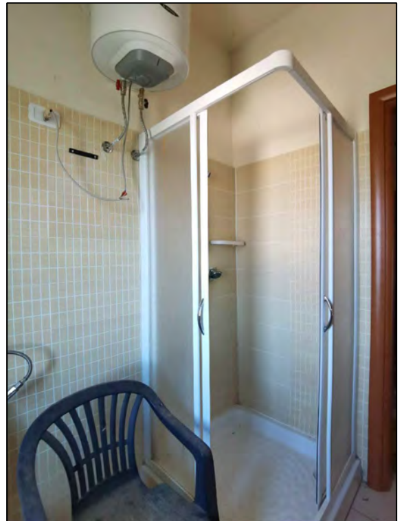
FOTO 95 - Lotto 2 - Corpo Y - Appartamento A (Bagno)
